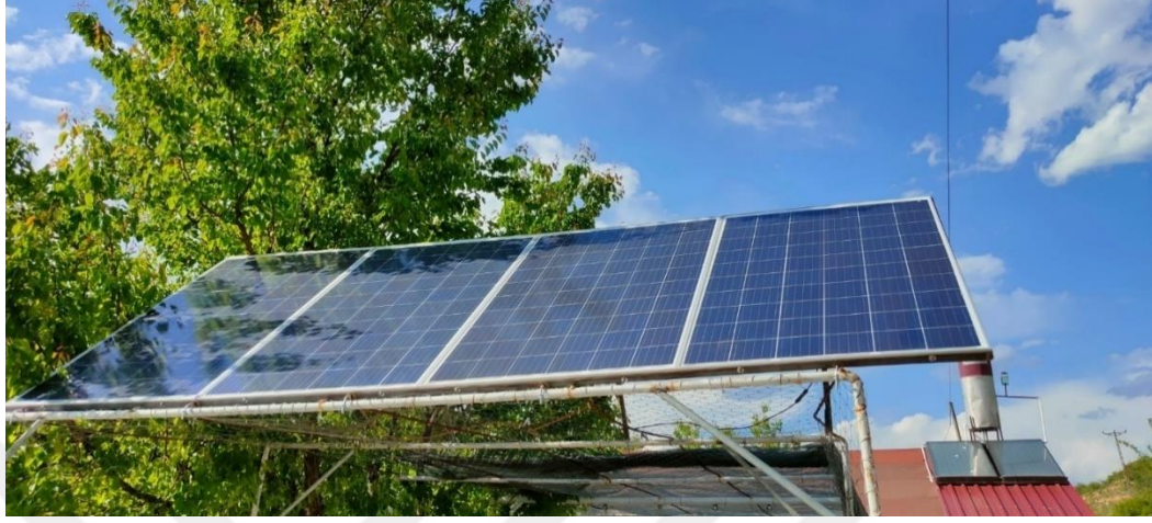
Şekil 3.13. Uygulama alanında kurulu olan güneş panelleri
