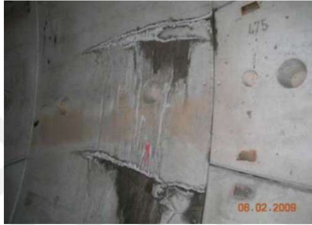
Şekil 5.3. Yapım sırasında sıralanan segmentte görünen çatlaklar
