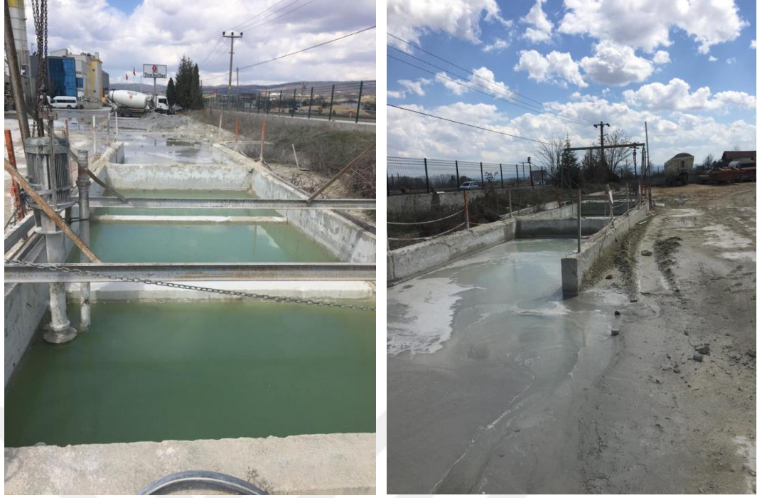
Şekil 3.2 Hazır beton santralinde çökeltme havuzu
