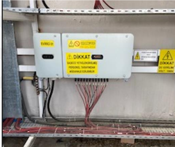
Şekil 1. 5. Yenilenebilir enerji uygulamalarında kullanılan DC/AC invertör.
