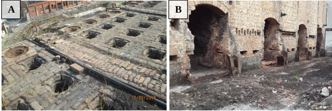
Şekil 4.54 : A ve B: R Binası restorasyon uygulaması öncesi üst örtü ve cephede görülen deformasyonlar (Gürsoy Grup Restorasyon, 2014).
