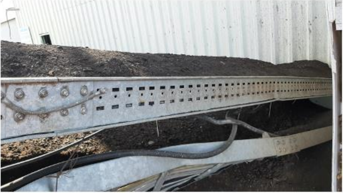
Şekil 3. 13. Kablolarda Birikin Kömürlerin Oluşturduğu Yangın Riski
