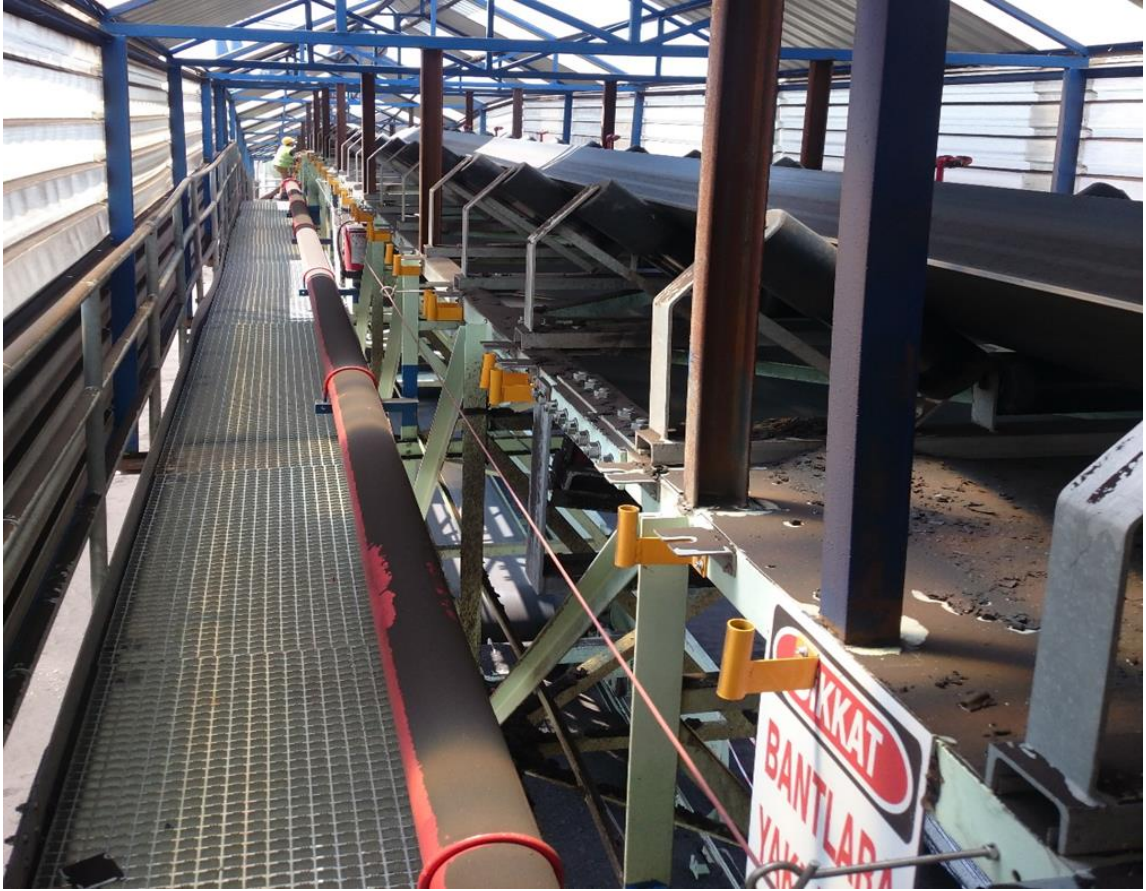
Şekil 3. 10. Konveyör Bant Önlemleri
