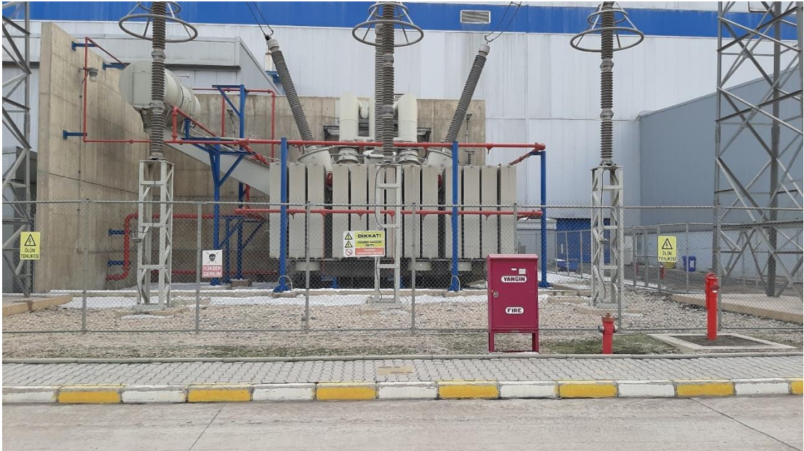
Şekil 3. 26. Trafoları Koruyan Yangın Koruma Sistemleri
