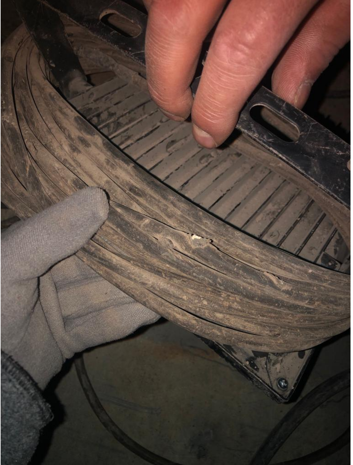
Şekil 3. 29. Hasarlı Elektrik Ekipmanı
