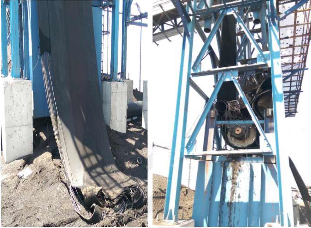
Şekil 3. 45. Kömür Bant Konveyör Yangını
