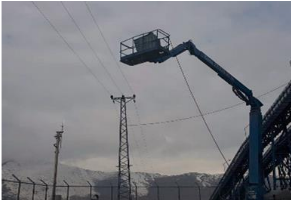
Şekil 3. 44. Yüksek Gerilim Hattı Yakınında Uygunsuz Çalışma
