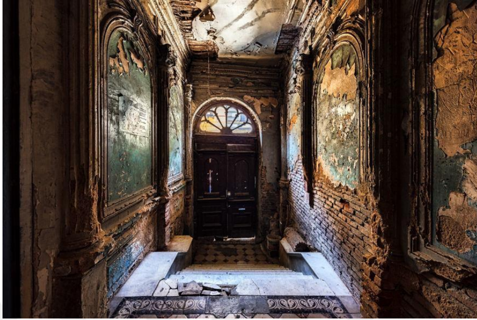
Görsel 3.2 Eski Tiflis'te (Mtatsminda Senti) Bulunan Hasarı Görmüş Tarihi Ev
