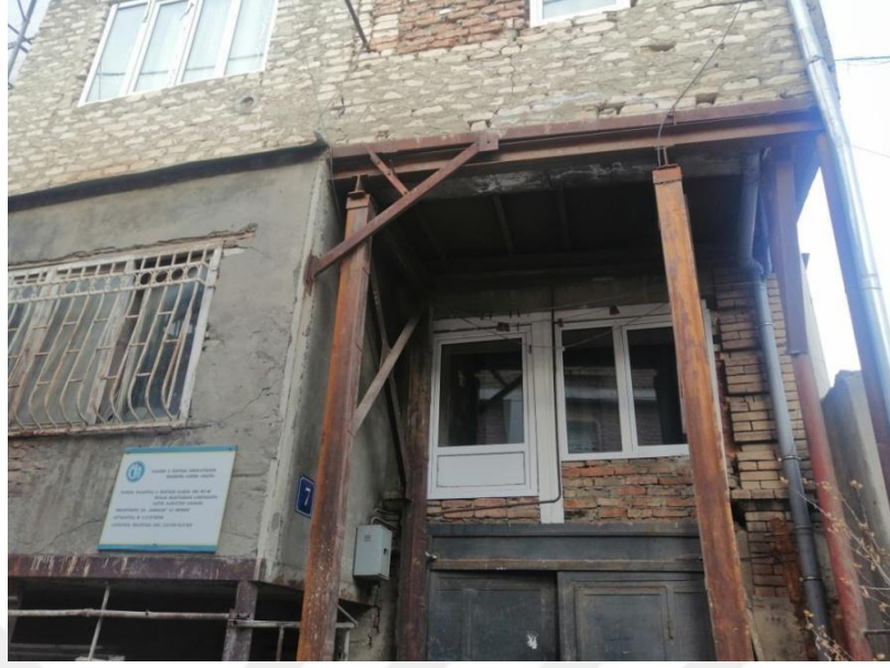
Görsel 3. 3 Hasar Görmüş Ev – Mtatsminda Senti
