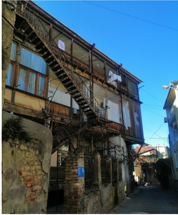
Görsel 1. 10 Mtatsminda Senti, Hasar Görmüş Ev
