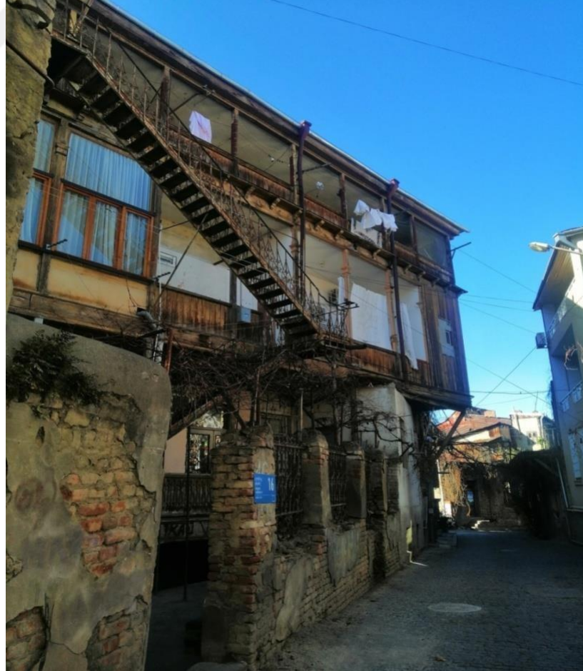
Görsel 3. 4 Hasar Görmüş Ev (Mtatsminda Senti)
