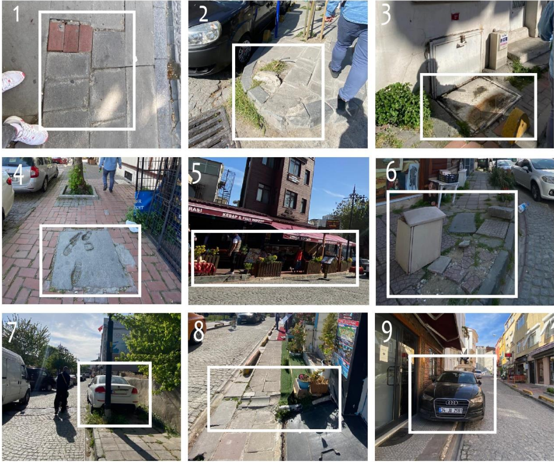
Şekil 3. 26 Kaldırımların sorunlu yüzeyleri ve engel oluşturan işgalleri (saha çalışmaları, 2022)
