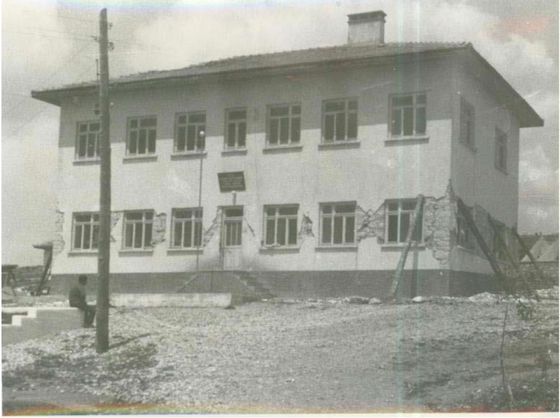
Şekil 2.9. Rijit kat döşemeli yapıda deprem hasarı (Bayülke, 2011)
