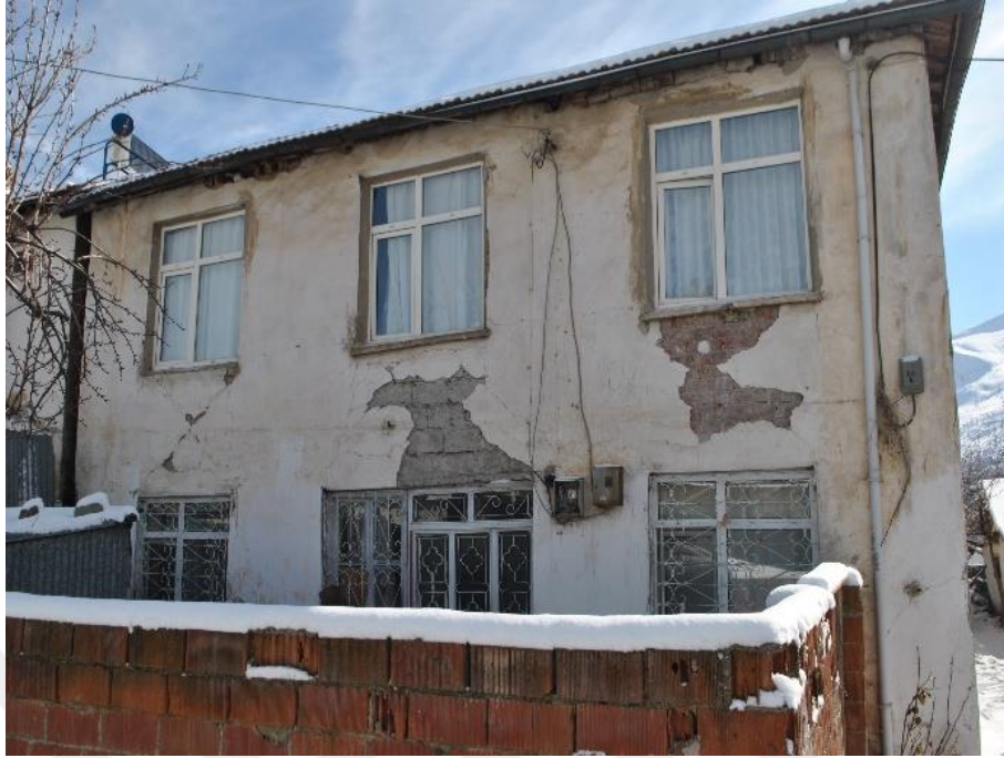
Şekil 2.7. Yığma yapı deprem hasarı
