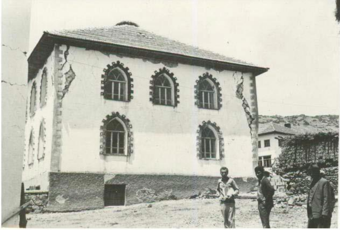
Şekil 2.10. Rijit kat döşemesi bulunmayan yapıda deprem hasarı (Bayülke, 2011)
