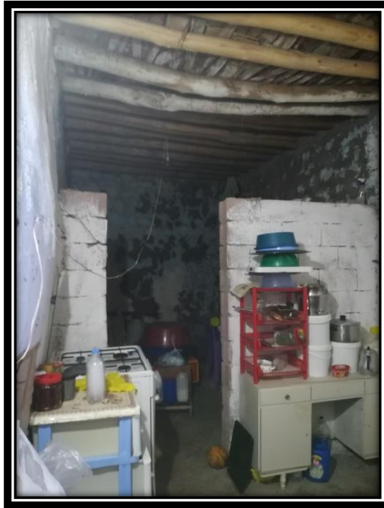
Şekil 3.112. Z05 Mahalindeki Ahşap Kirişlemelerin Genel Durumu
