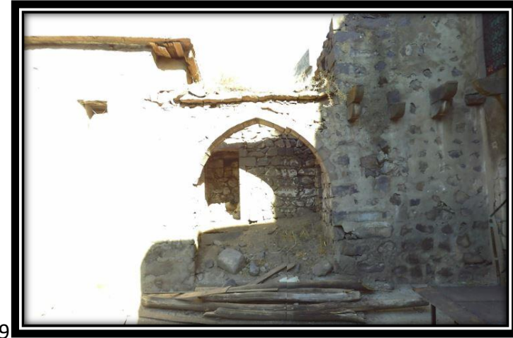
Şekil 5.67. Z2 Avlunun Doğu Cephesinde Taşlarda Bozulma ve Kırılma Örneği
