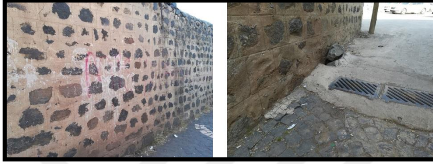
Şekil 3.71. Doğu Cephesindeki Duvar Yazıları ve Batı Cephesindeki Altyapı Sorunları
