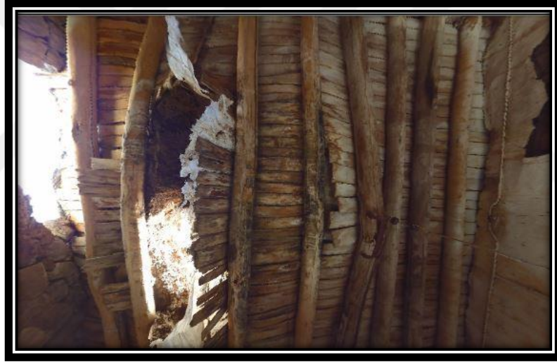
Şekil 5.69. B7 Mahalinde Kısmen Yıkılmış Tavan Örneği
