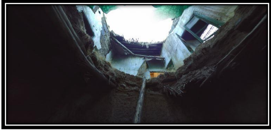
Şekil 5.71. Yıkılan Döşeme Örneği
