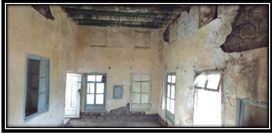
Şekil 5.68. B4 Mahalinde Sıvada Çatlama ve Dökülme Örneği
