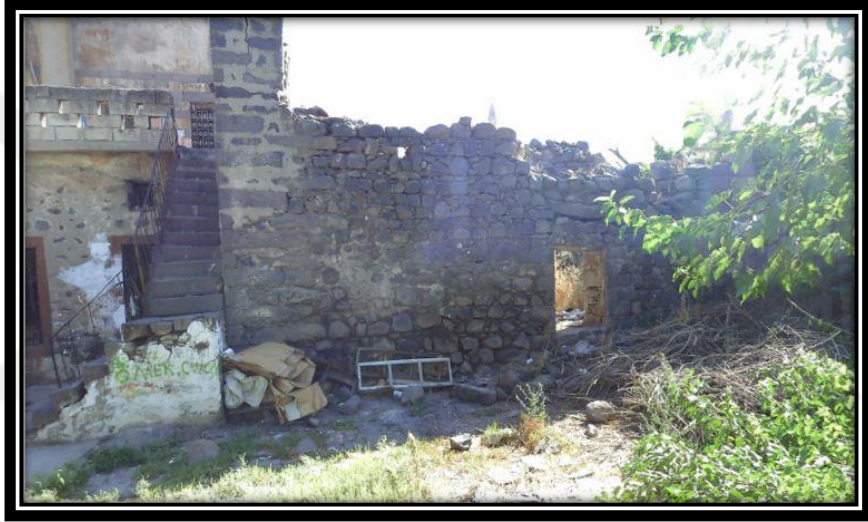
Şekil 5.72. Z11 Mahalde Kırılan Döşeme ve Tavan Örneği
