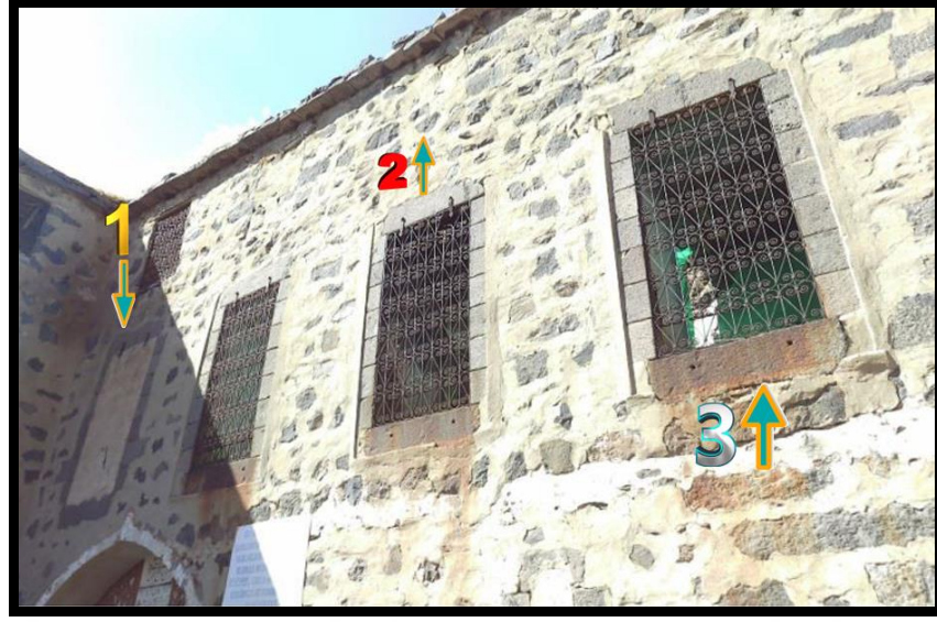
Şekil 5.102. 1) Yapı izleri kapatılmış pencere 2)Kapatılmış tepe penceresi izi 3)Ahşap kapak izleri
