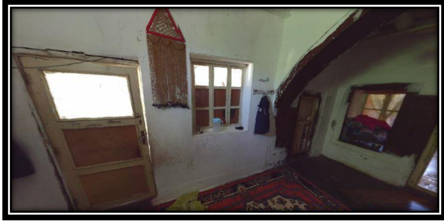
Şekil 5.62. Z4 Mahali Doğu Duvarı Üzerindeki Özgün Olmayan Pencere
