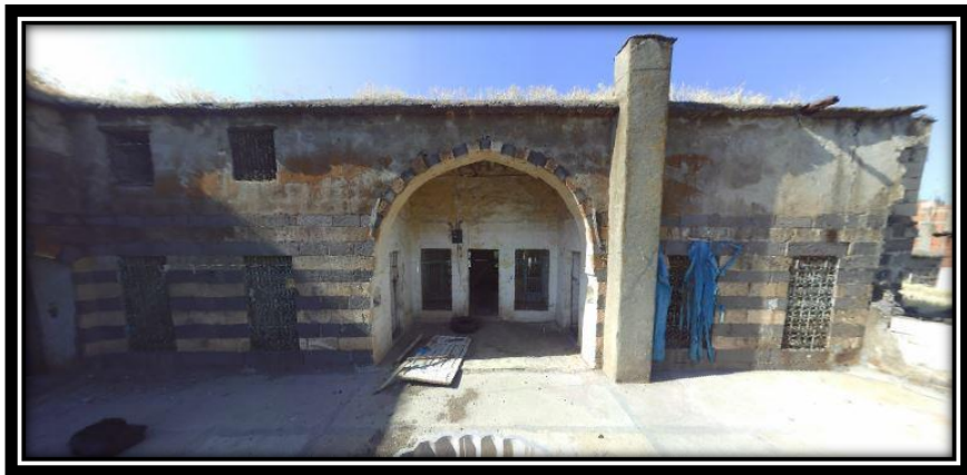
Şekil 5.70. Çatıda Bakımsızlıktan Kaynaklı Bitkilenme Örneği
