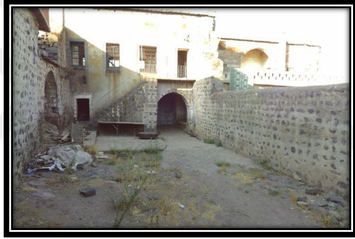
Şekil 5.66. Z2 Avlunun Güneyinde Bulunan Yapının Cephesinde Renk Değişimi Örneği
