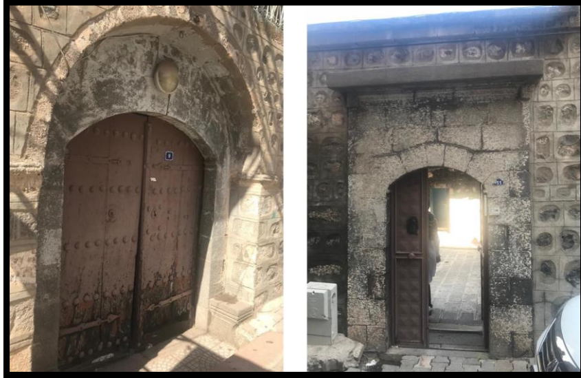
Şekil 3.150. Hasan Baylan Evi Orijinal Giriş Kapısı ve Alhaslar Evi Değiştirilen Giriş Kapısı
