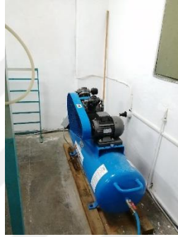
Şekil 3.12. Sisteme basınçlı havayı sağlayan hava kompresörü
