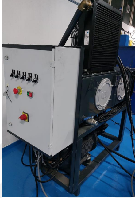
Şekil 5.2 Hidrolik güç ünitesi genel görünüm
