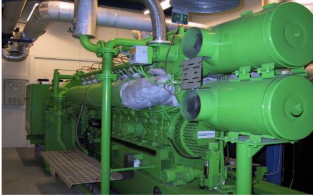
Şekil 5.17. Gaz Motoru/Jeneratör (Terraza and Willumsen, 2009).
