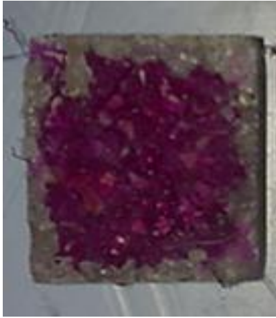
Resim 4.4. Betonda karbonatlaşma etkisi
