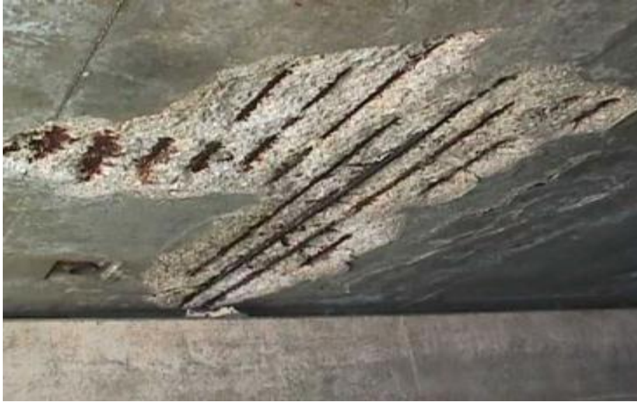
Resim 2.7. Karbonatlaşma sonucu donatı korozyonu [59]
