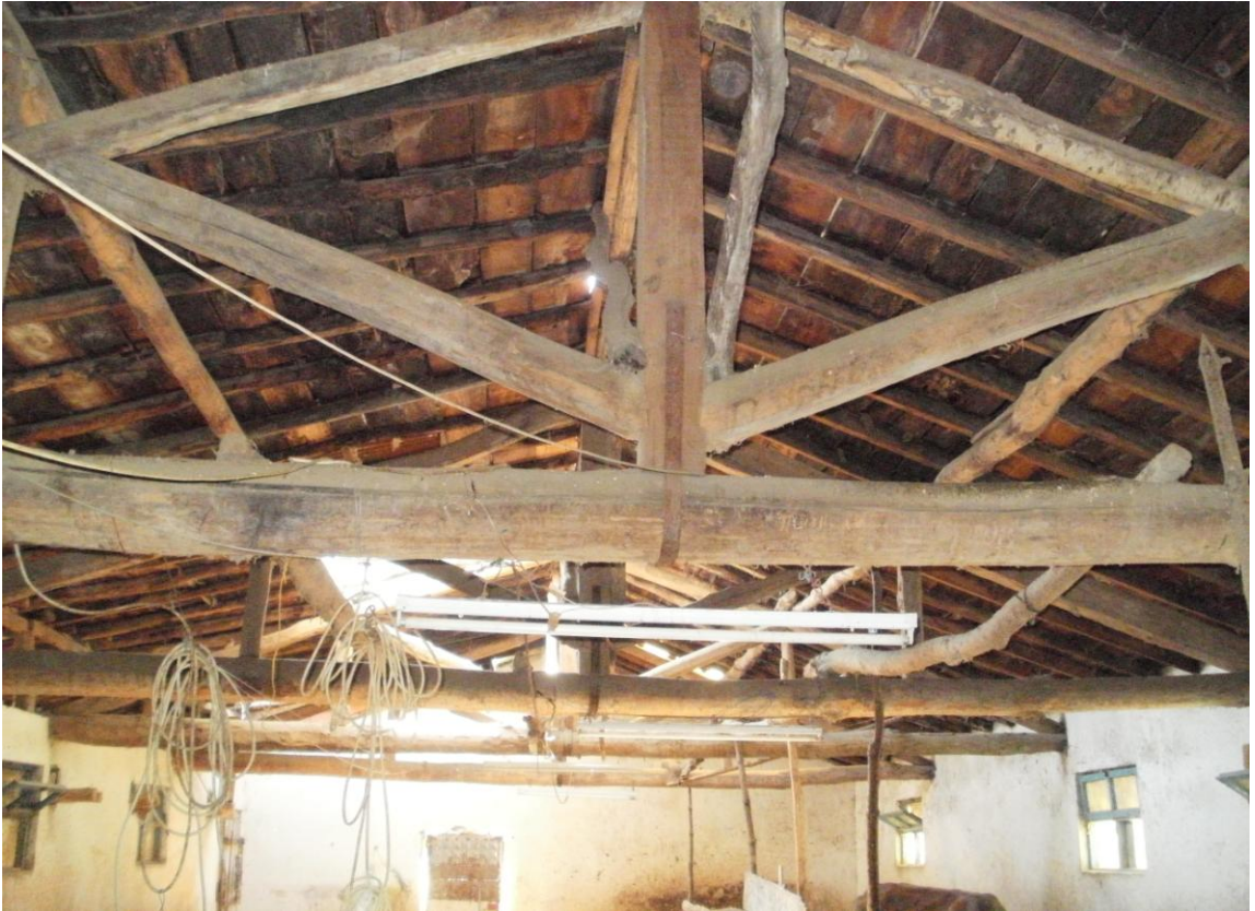
Şekil 4.1. Ahşap çatı elemanlarında meydana gelen nem yoğunlaşması ve deformasyon (2012).
