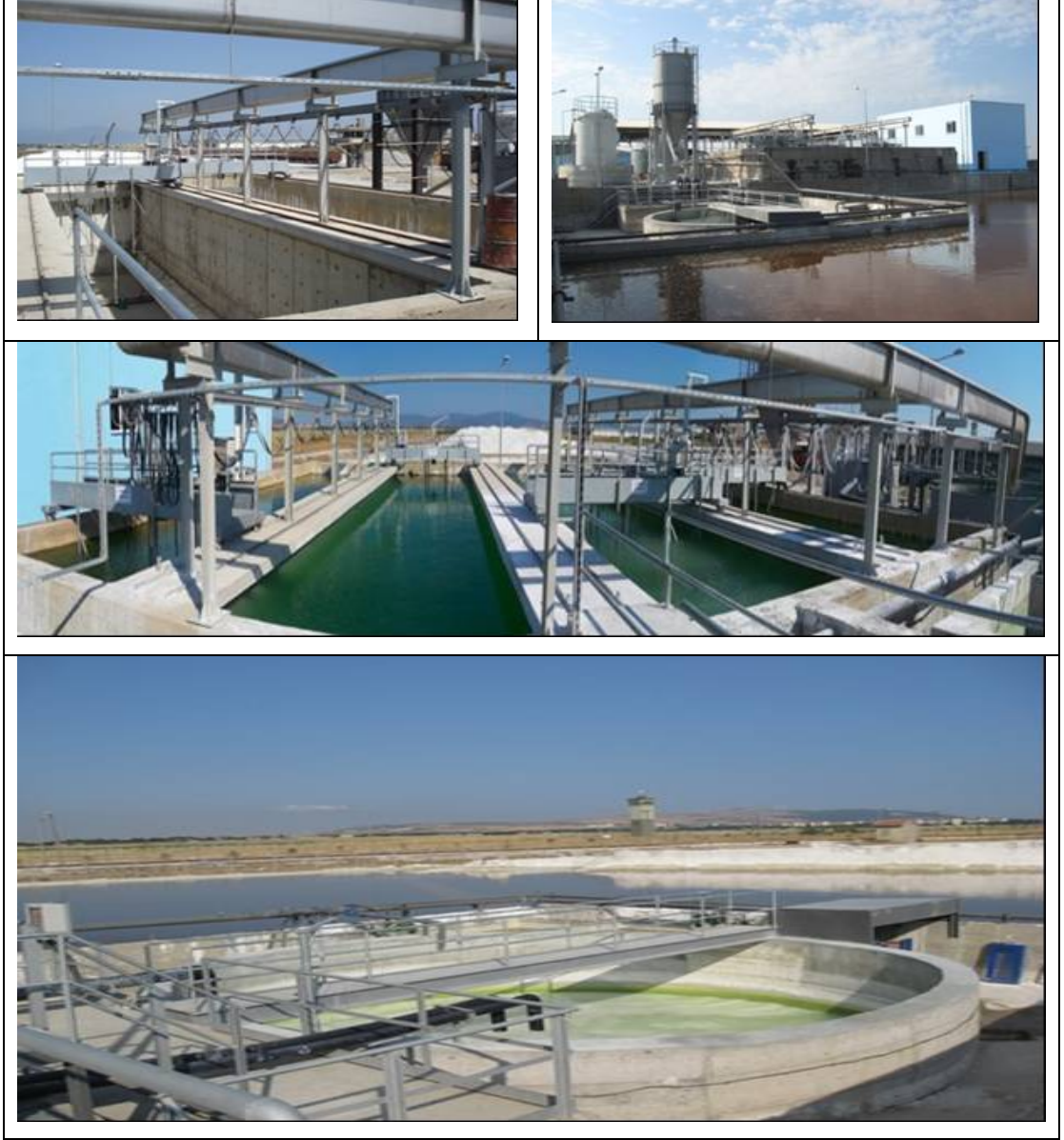
Resim 3.9. Atık arıtma tesisi
