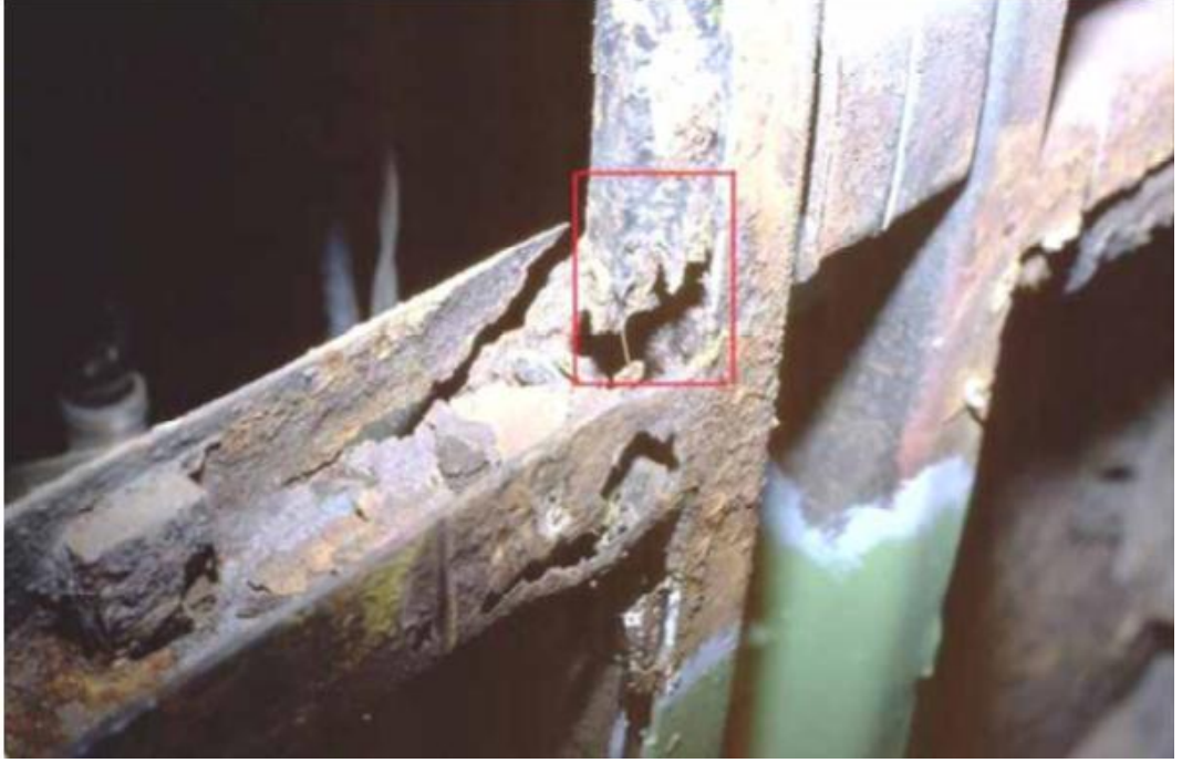
Şekil 1-1 Korozyon sebebiyle oluşan hasar (Kaftan, M.A. 2006 )
