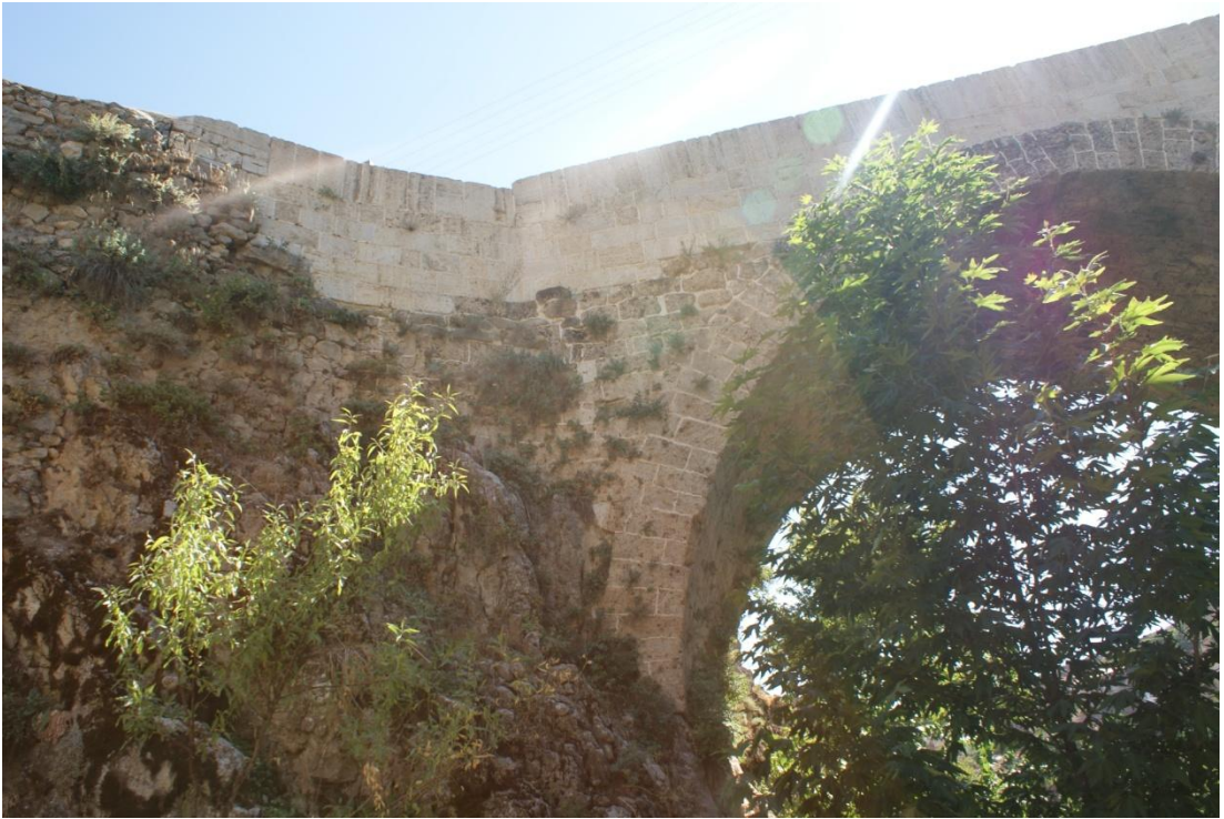
Resim 14: Çüngüş Köprüsü: Suyun kaynak tarafından köprü yolunun kırılma yaptığı yüz (Şafak Kutlay)
