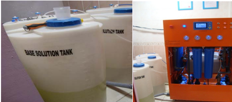
Resim 4.8. Asit-baz solüsyonu tankları
