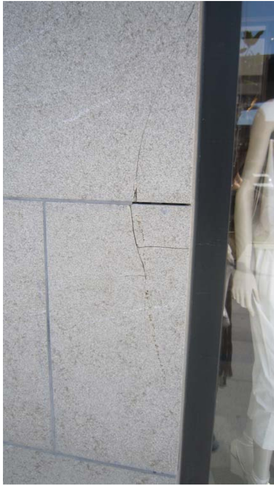
Şekil 4.27 : Seramikte oluşan çatlamlar.
