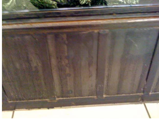
řekil 4.54 : Demir dođrama alt bazasında oluřan korozyon.
