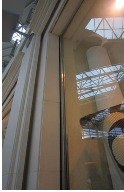
Şekil 4.48 : Doğrama ile kolon kaplaması arasındaki düşeyden sapma.
