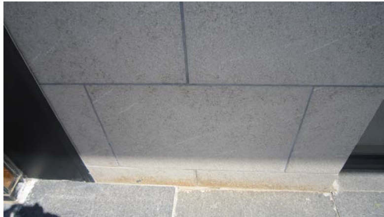
Şekil 4.30 : Seramikte oluşan korozif kirlenme.
