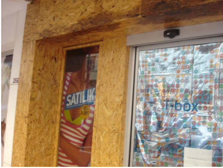
Şekil 4.43 : OSB kaplamada oluşan hasar
