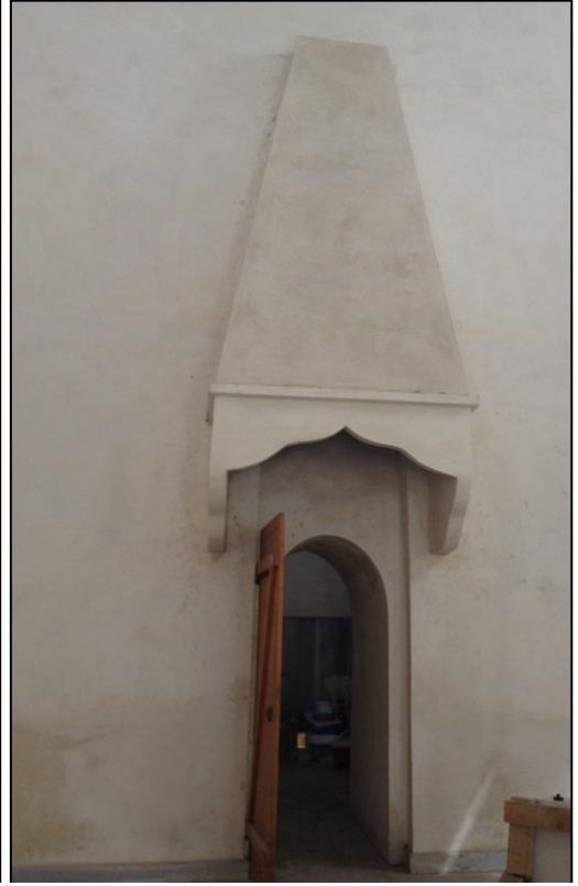
Şekil 2.16. Beyazıt Hamamı, Buhar Yaşmağı (13.05.2012)
