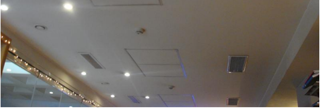
Resim 3.109: Aşk Kahve, asma tavan içerisinde aydınlatma elemanları
