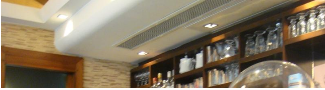
Resim 3.121: Cafe Wien, havalandırma
