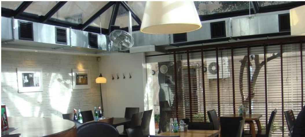
Resim 3.123: Den Cafe & Restaurant, havalandırma
