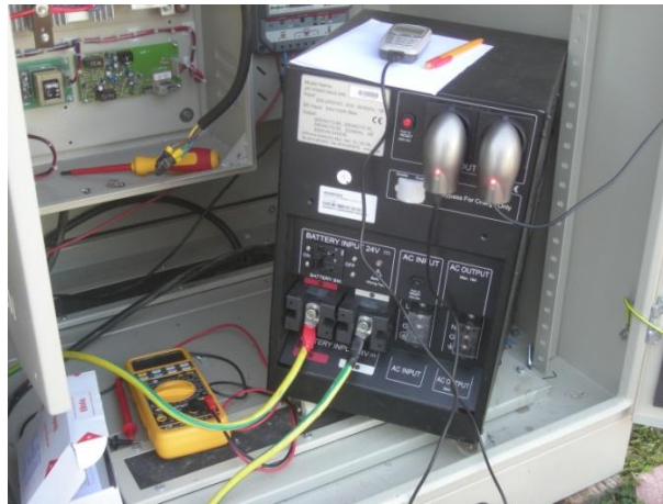
Şekil 3.13 : Donanım dolabında yer alan inverter.
