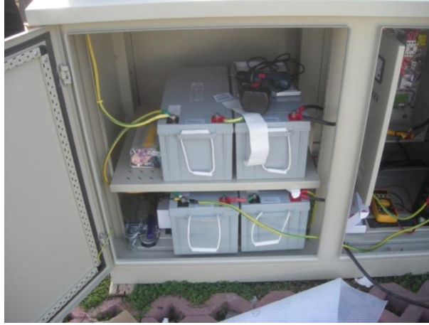
Şekil 3.14 : Donanım dolabında yer alan akü grubu.
