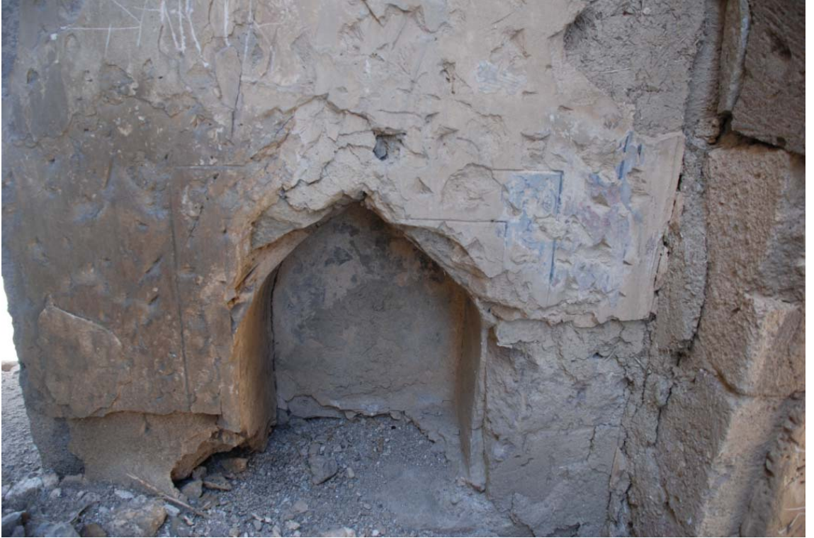
Foto 105: Selamlık Bölümünde Tahrip Olan Kalem İşleri
