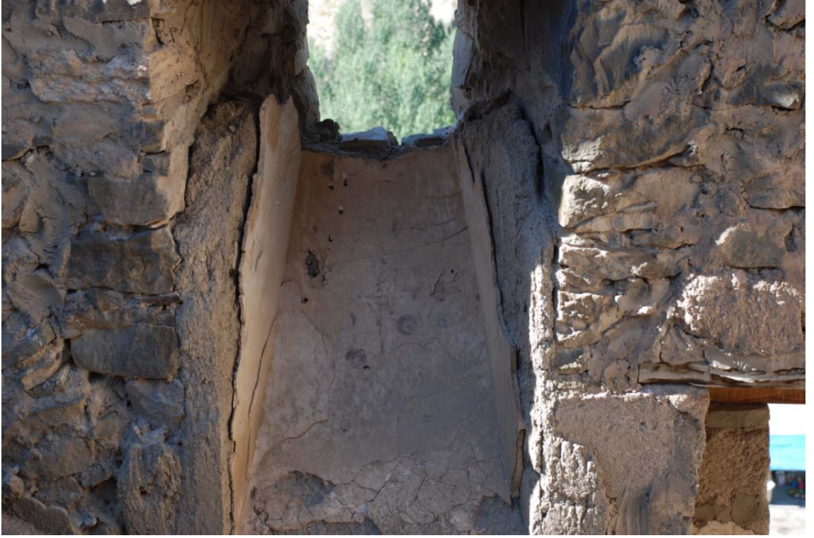
Foto 104: Selamlık Bölümünde Tahrip Olan Kalem İşleri
