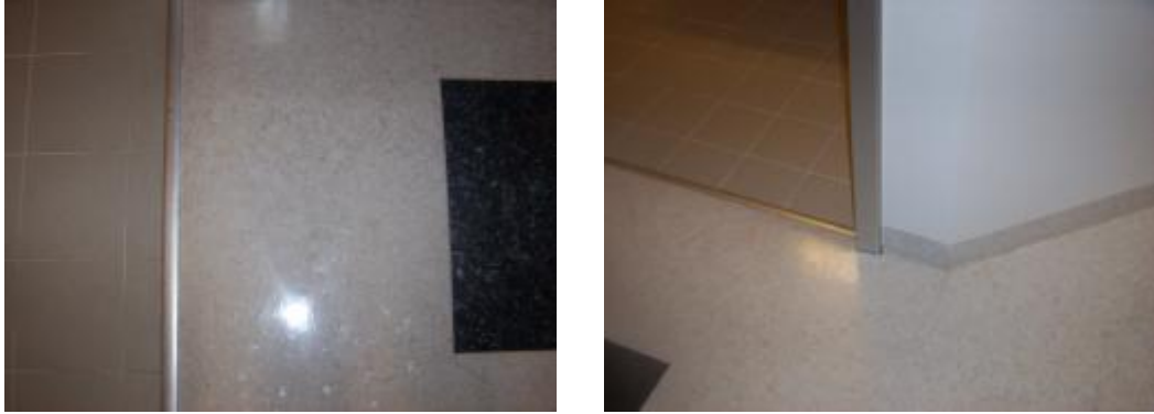
Şekil 55. Metropark Hastanesi hasta odası - ıslak hacim zemin malzemesi
