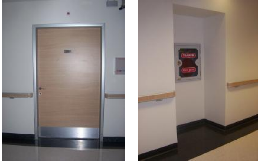
Şekil 42. Metropark Hastanesi hasta odası kapıları ve koridorda niş içinde yangın dolapları
