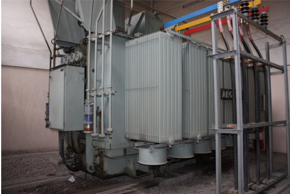
Resim 6.2. Maltepe GIS transformatör merkezi 25 MVA transformatör-1
