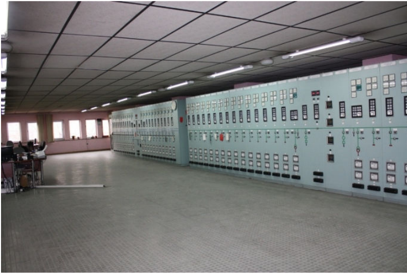
Resim 6.1. Maltepe GIS Transformatör Merkezi'nden bir görünüm
