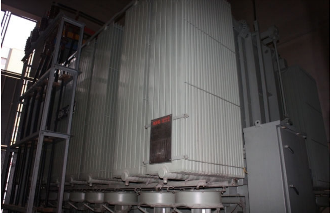
Resim 6.3. Maltepe GIS transformatör merkezi 100 MVA transformatör-2
