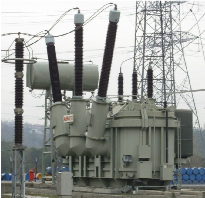
Resim 2.1. TEİAŞ transformatör merkezindeki bir güç transformatörü
