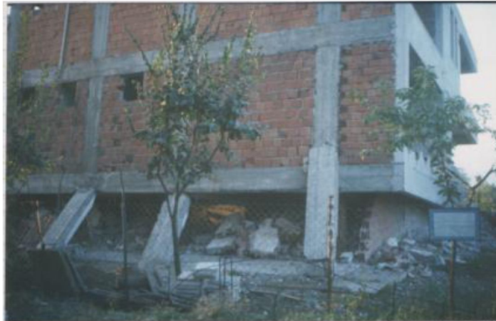
Şekil 2.5 : 1999 Kocaeli depreminde zayıf kat hasarı [18].
