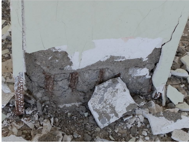
Şekil 6.25 : S111 Kolonu alt ucundaki donatı burkulması.
