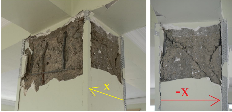
Şekil 6.24 : S111 Kolonu üst ucu kesme hasarı ve donatı burkulması.
