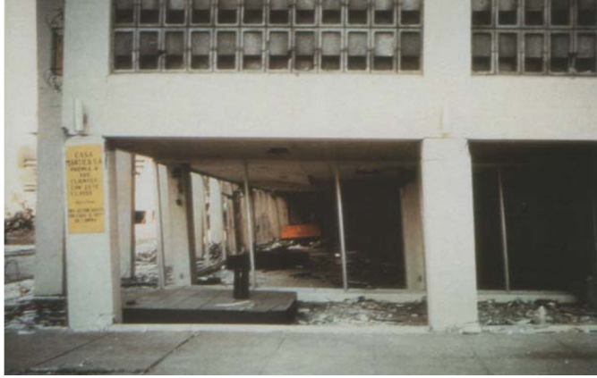
Şekil 2.4 : Casa Micasa Binası zayıf kat hasarı, 1972 Managua-Nicaragua depremi (M6.2) [18].
