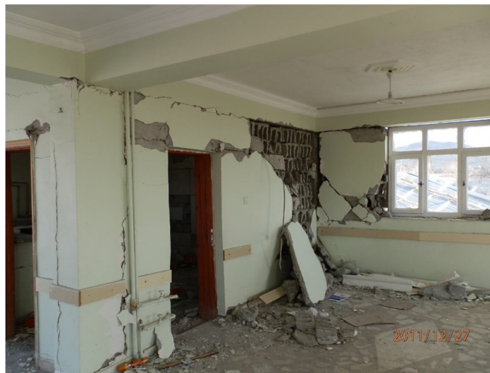
Şekil 6.34 : 1.Normal kat duvar hasarı.
