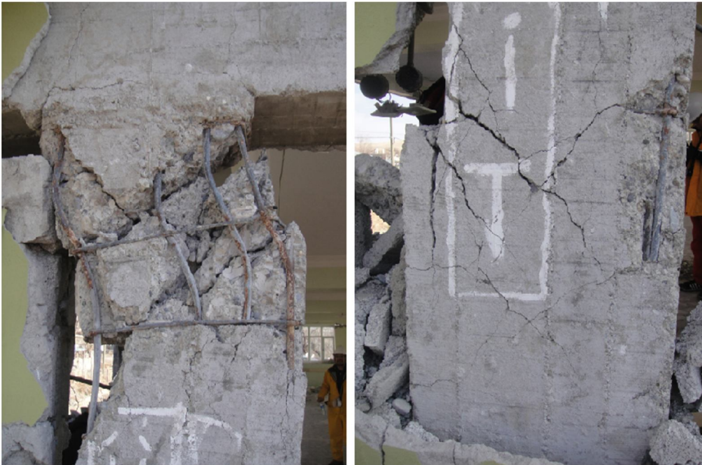
Şekil 6.16 : S114 kolonu üst ve orta bölgesinde oluşan çatlaklar.
