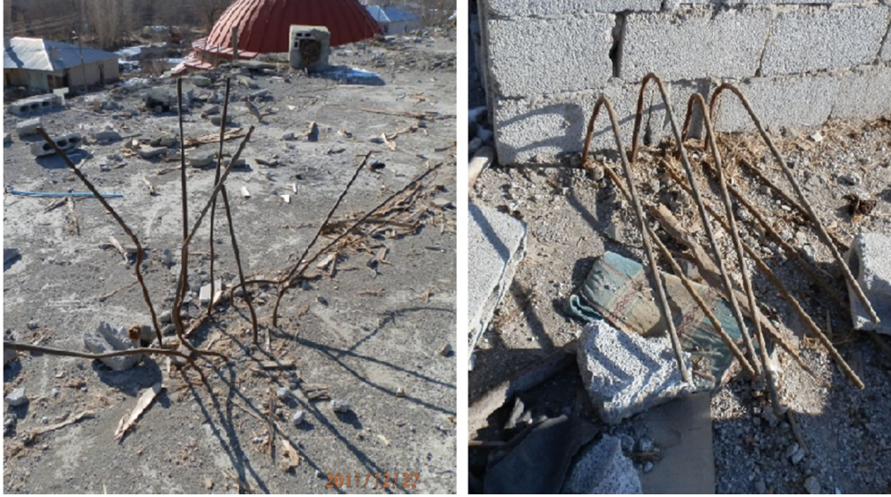
Şekil 6.13 : Çatıdaki kolon filizleri.
