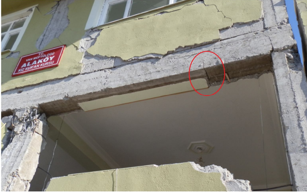
Şekil 6.22 : K110 Kirişi eğilme çatlağı.
