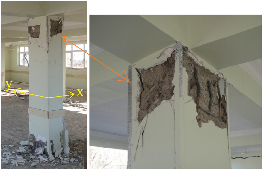
Şekil 6.23 : S111 Kolonu kesme hasarı ve donatı burkulması.
