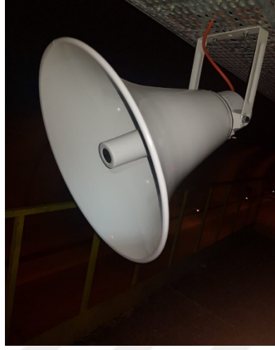
Şekil 3.15: Tünelde Kullanılan Kamu Anons Sistemi.
