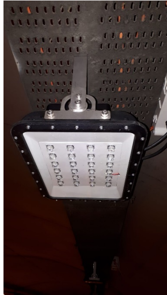
Şekil 3.8: Tünelde Kullanılan İsbak LED Armatürü.
