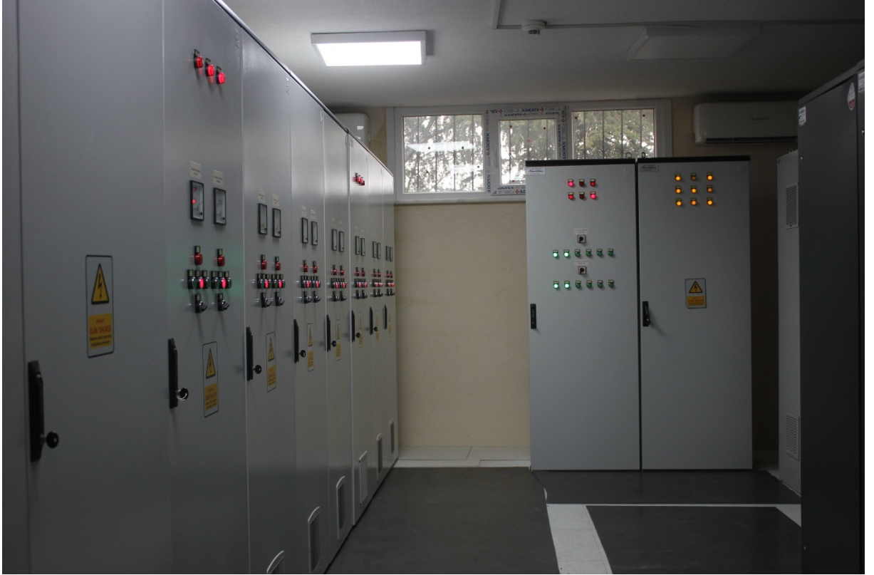
Şekil 4.2: Ana Dağıtım Pano Odası.
