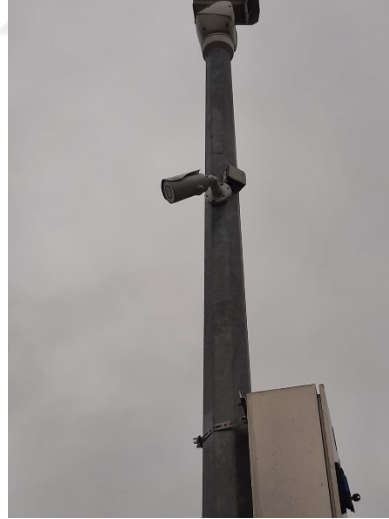
Şekil 3.12: Tünel Girişinde Direk Üzerinde Bulunan Kamera Sistemi.
