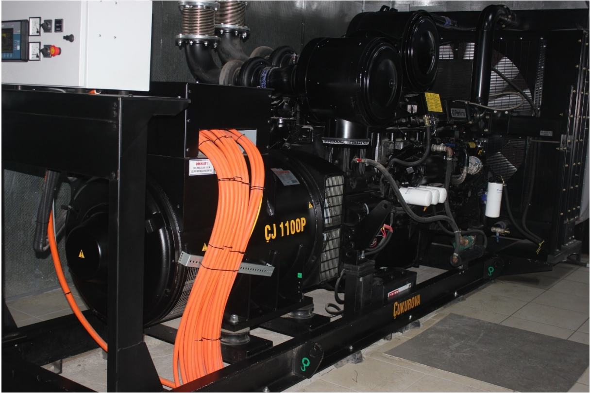
Şekil 3.3: Tünel İşletme Merkezinde Jeneratör Gösterimi.
