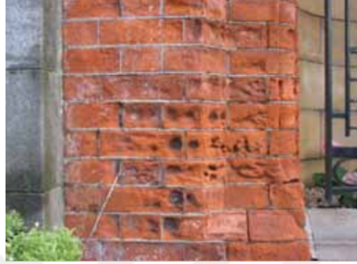
Şekil 2.35 : Harçın tuğladan daha güçlü olduğu durumlarda tuğladaki bozulma (Donnelly, 2009).
