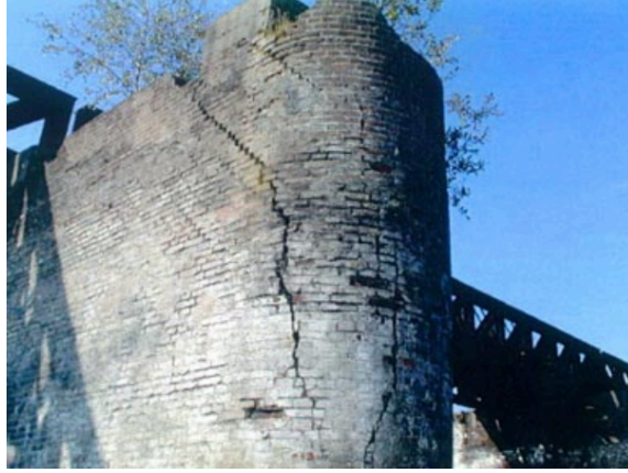
Şekil 2.38 : Duvarda, yapısal hasar gibi görünen ancak harcın iç kısmındaki geniş reaksiyonun neden olduğu çatlak deseni (Lourenço ve diğ, 2014).
