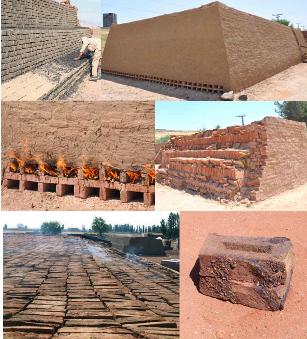
Şekil 2.8 : Sırası ile, tuğla bloklar arasında kömür serilmesi (Er, 2013), dışı sıvanmış kesik piramit şeklindeki fırın, yanıcı malzemenin yerleştirilip yakıldığı hava delikleri, pişirilmiş ve bir kısmı sökülmiş tuğlalar (Dalkılıç ve Nabikoğlu, 2017), yanmakta olan sahra fırınının üstten görünüşü ve fazla ısı sebebi ile zihterleşmiş tuğlalar (Er, 2013).
