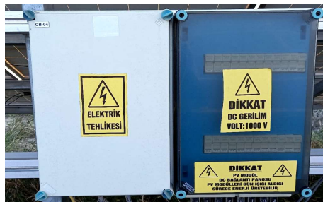
Şekil 3. 4. GES tesisi saha DC toplama panosu
