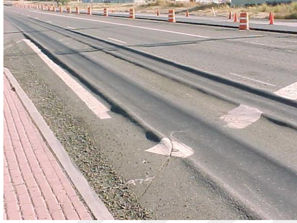
Şekil 3.1. Tekerlek izi deformasyonu
