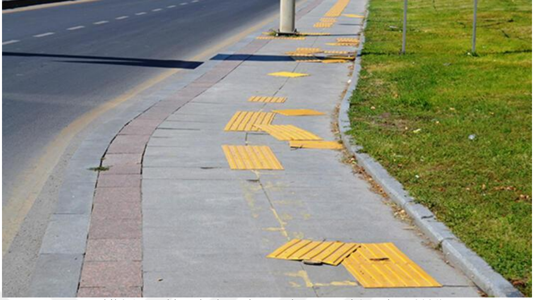
Şekil.2.14. Kaldırımlarda yanlış uygulama örneği (Hürriyet, 2021)
