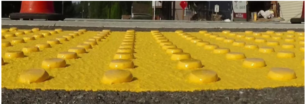
Şekil 2.36 Asfalt hissedilebilir yüzey örneği
