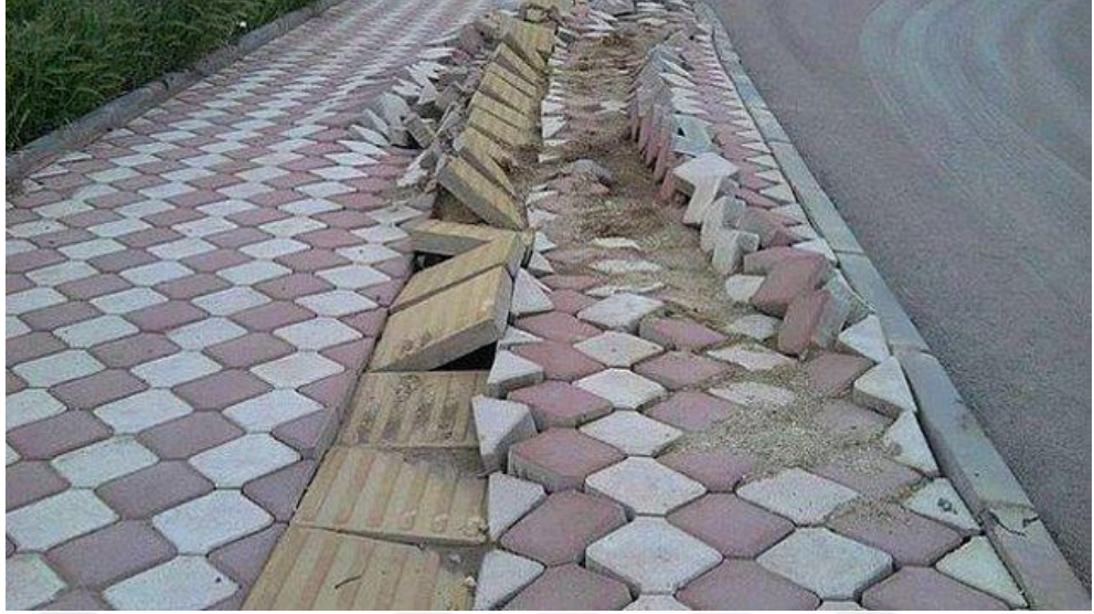
Şekil.2.16. Kaldırımlarda yanlış döşeme örneği (Onedio, 2021)
