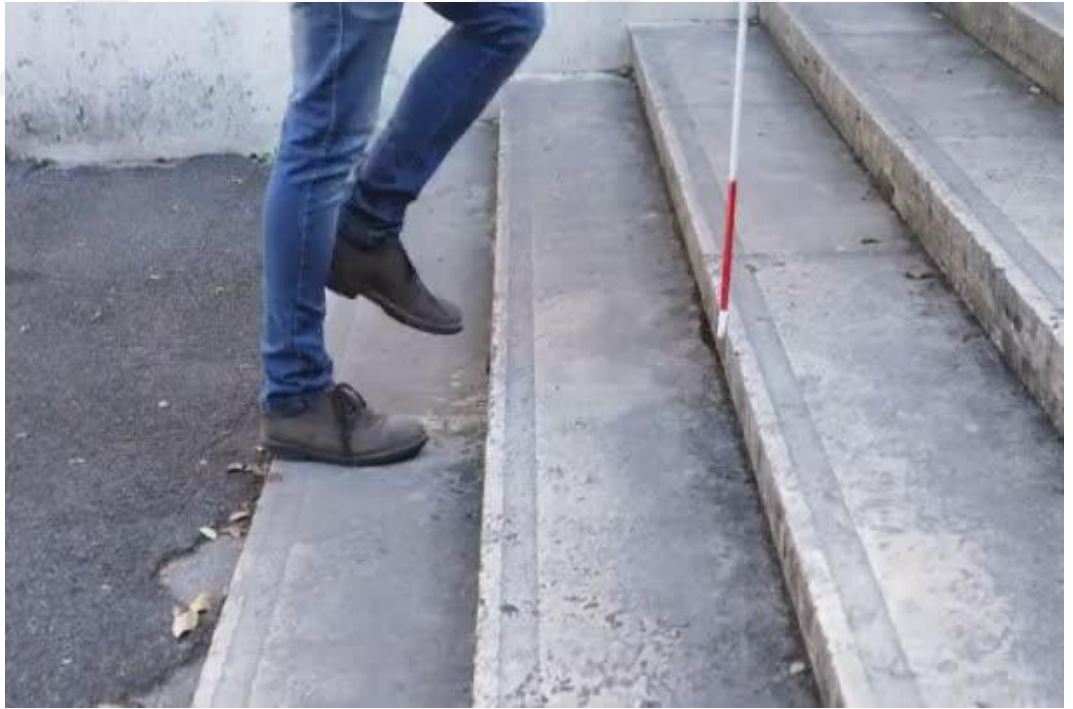
Şekil.2.12. Merdivenler, Rampa sorunları v.b. (Deadwood, 2021)
