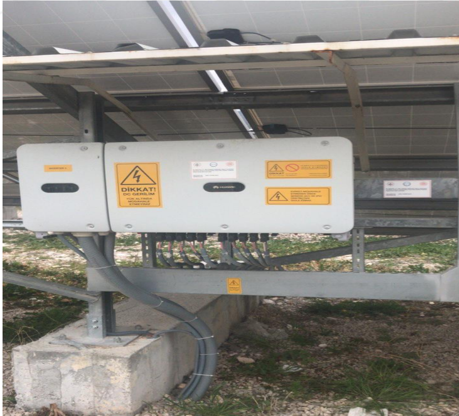
Şekil 4.24. Sistem üzerindeki inverter
