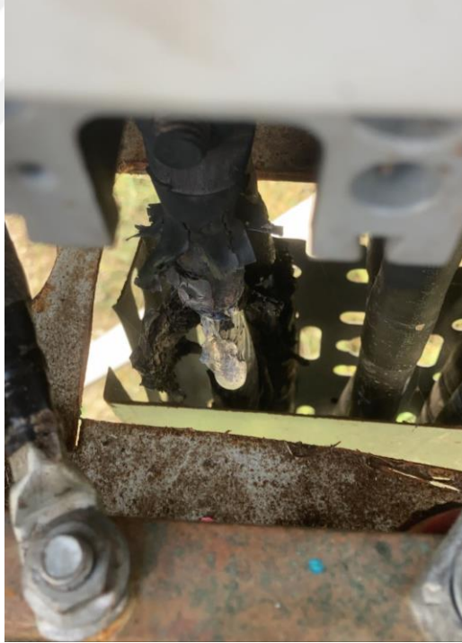
Şekil 4.13. Trafo bağlantı hatası
