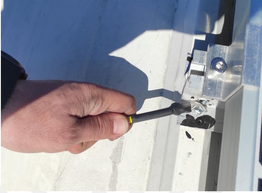
Şekil 4.12. Topraklama kablosu bağlantı hatası
