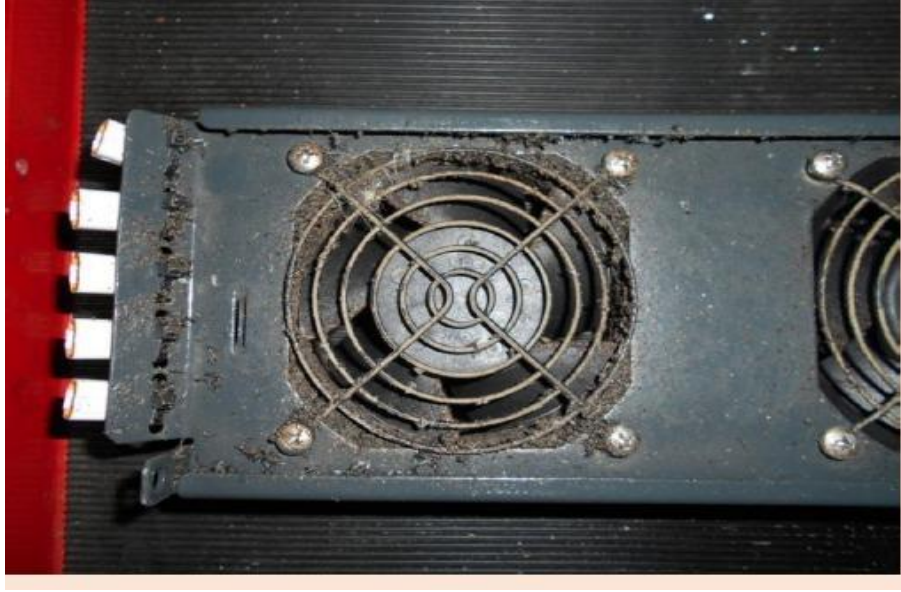
Şekil 4.23. İnverter fanı tozlanması
