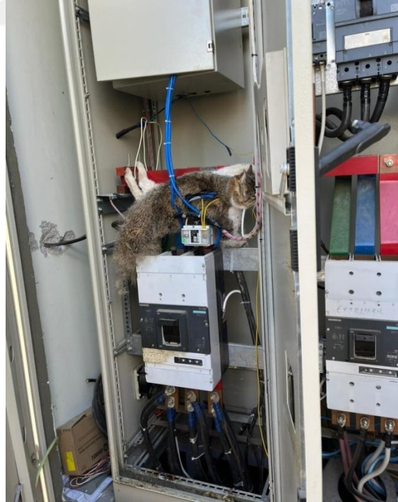
Şekil 4.19. Canlı hayvanların pano içerisine girmesi sonucu oluşan kısa devre
