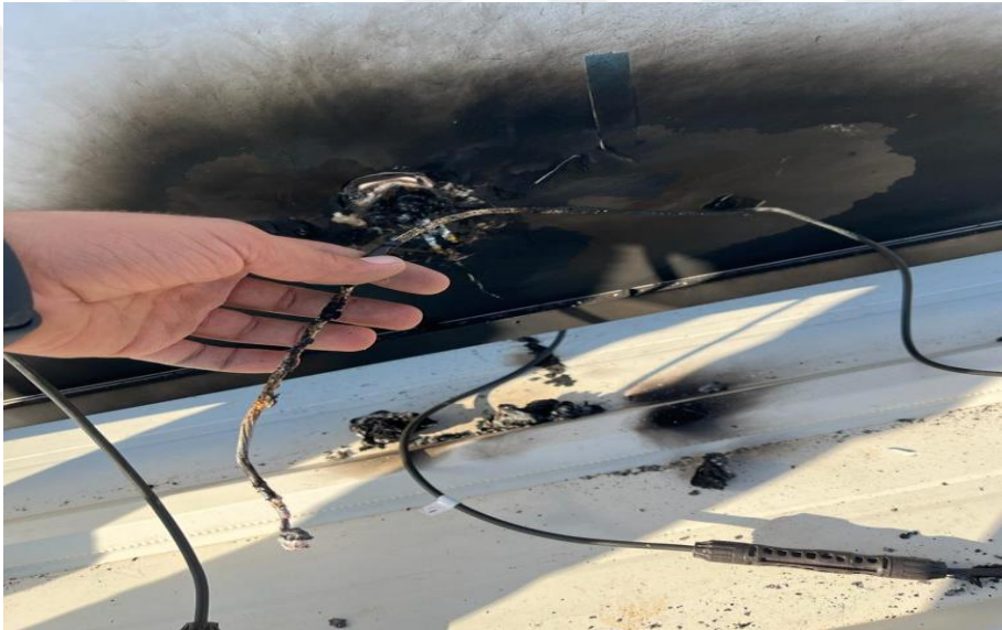
Şekil 4.25. Kısa devre sonucu yanmış kablolar
