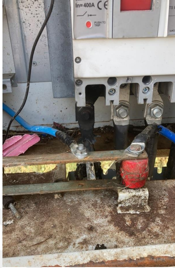
Şekil 4.20. Kablo ucu pabuçlarında oluşan kirlenme sonucu oluşan iletim hatası
