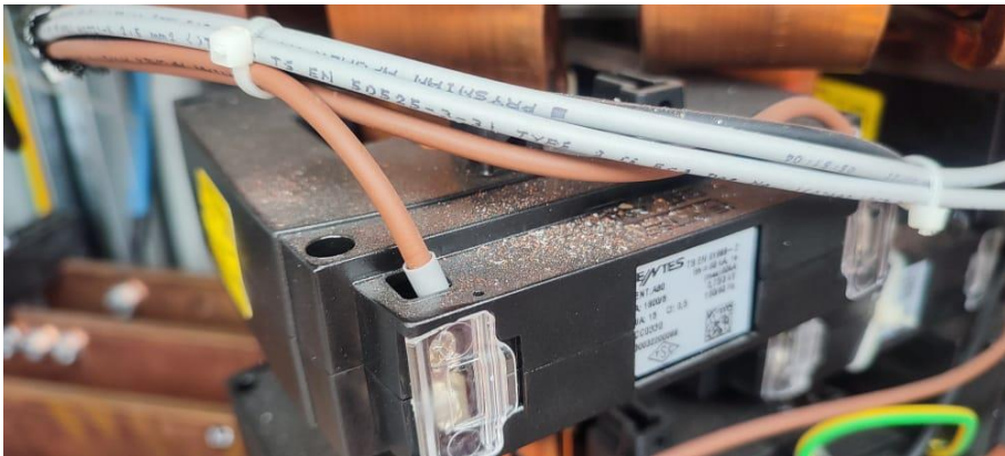
Şekil 4.26. Bakır kablo parçacıklarının neden olduğu kısa devre
