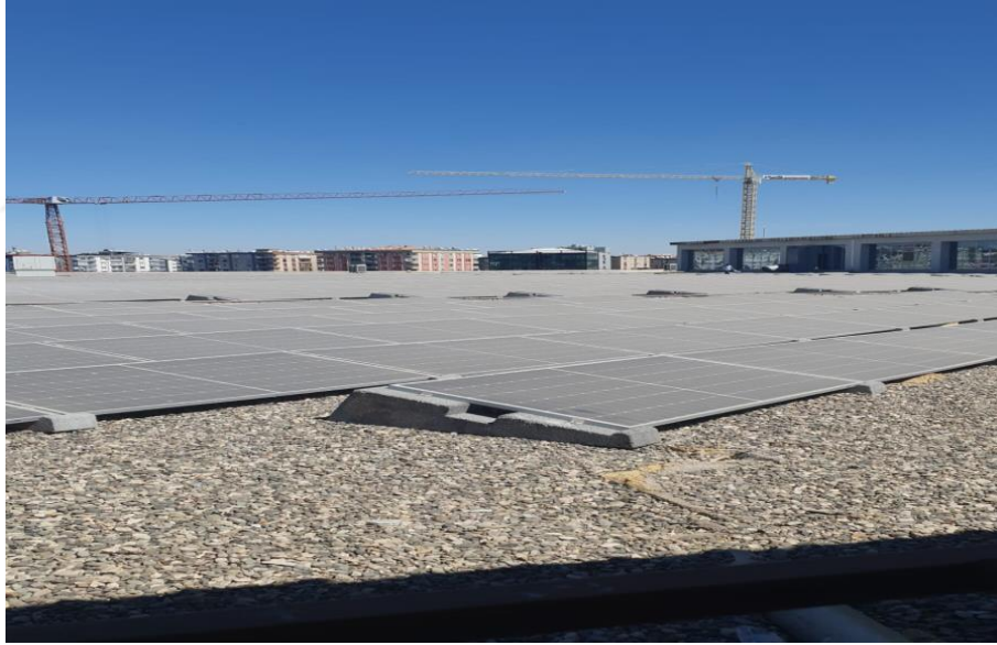
Şekil 4.1. Tozlanmış fotovoltaik paneller
