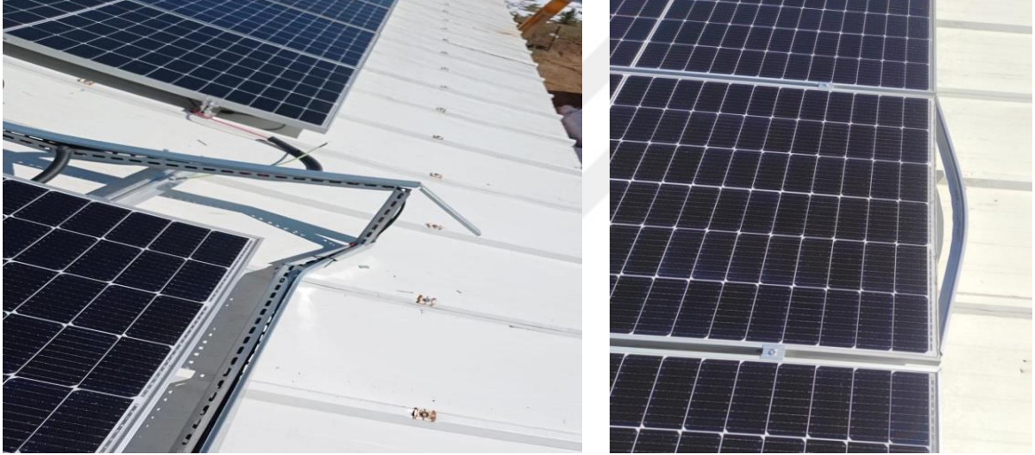
Şekil 4.3. Aşırı kar yağışı sonrasında zarar gören paneller
