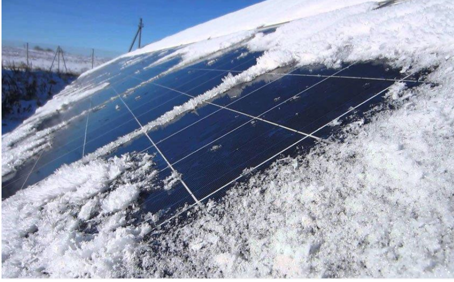
Şekil 4.2. Kar yağışı sonrası fotovoltaik paneller (URL-25, 2022)
