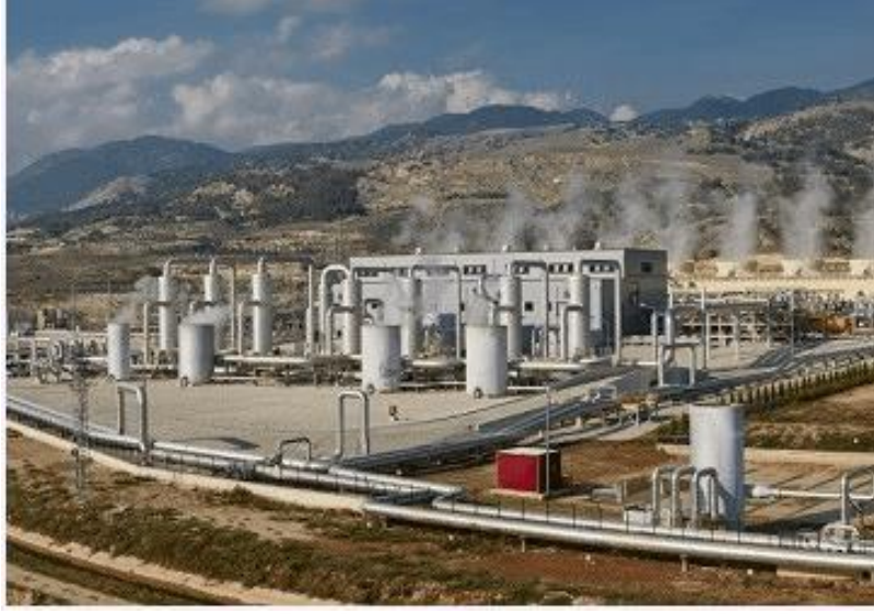
Fotoğraf 1.4. Denizli Jeotermal Enerji Tesisi
