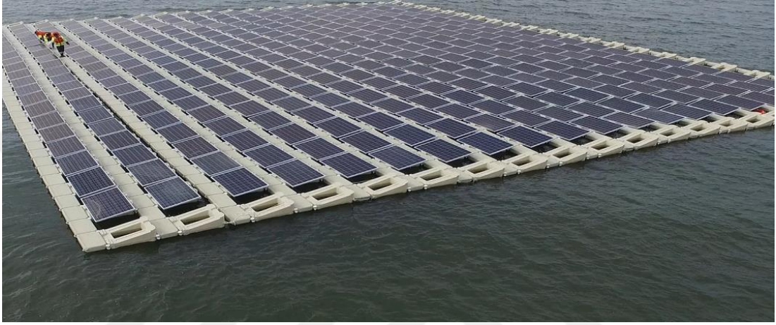
Şekil 2.7. Yüzer güneş enerji santrali Büyükçekmece gölü. ( http://www.enerjiatlasi.com , 2021)
