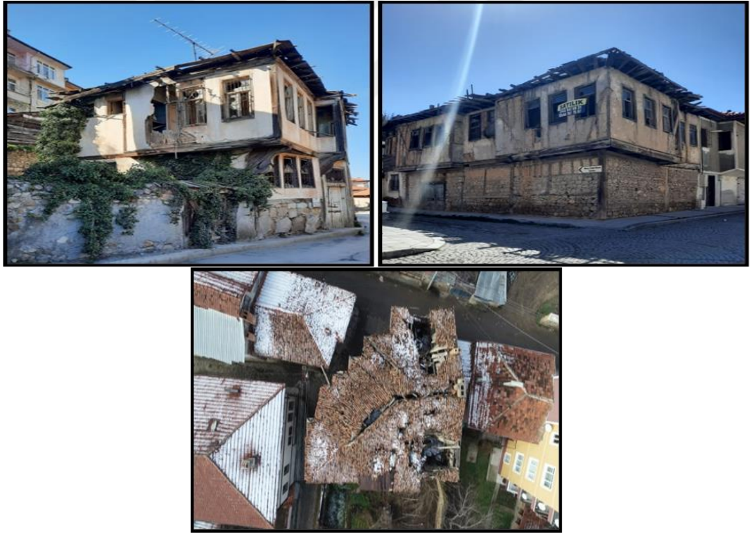
Şekil 4.20 Bakım ve onarımı gerçekleştirilmemiş ve alanda tehlike riski oluşturan tescilli binalar (Kastamonu Belediyesi, 2022)
