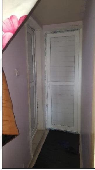
Şekil 33. 104-105 Mekanlarındaki Özğün Olmayan Kapılar Kaynak: Ömerođlu, 2022
