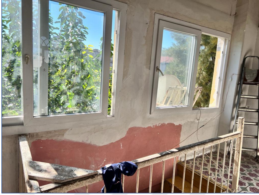
Şekil 40. 206 Bölümünde Görülen Bozulmalar
