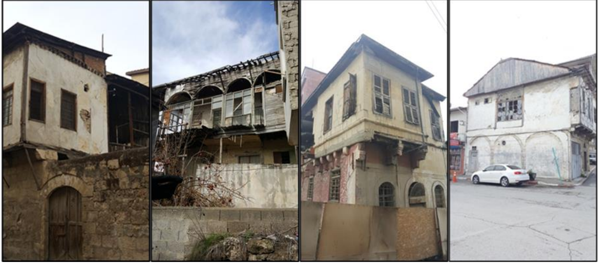
Şekil 15. Tarsus Şehit Kerim ve Cami Nur Mahallelerinde Bulunan Geleneksel Evlerde Kullanılan Hatalı Malzeme Sonrası Görülen Bozulma Örnekleri
