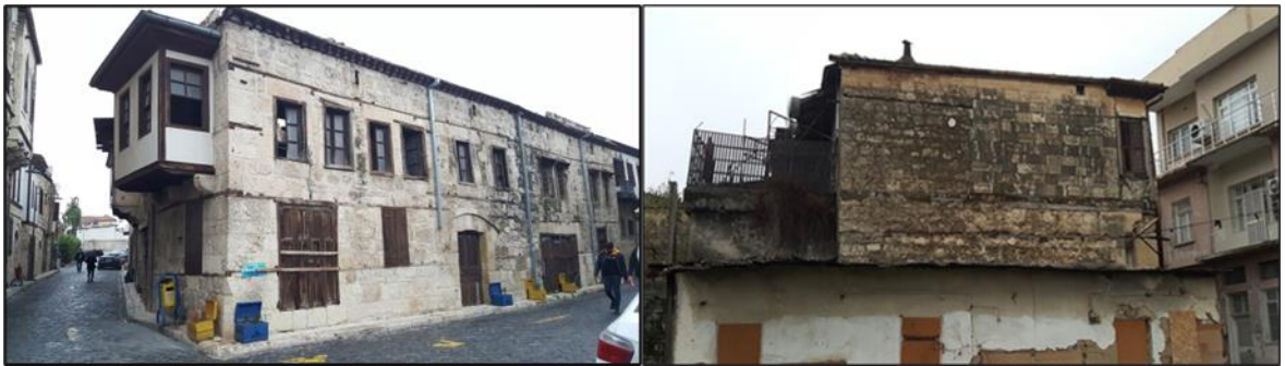
Şekil 16. Tarsus Kızılmurat Mahallesinde Bulunan Geleneksel Evlerde Kötü İşçilik Sonrası Cephede Görülen Bozulma Örnekleri
