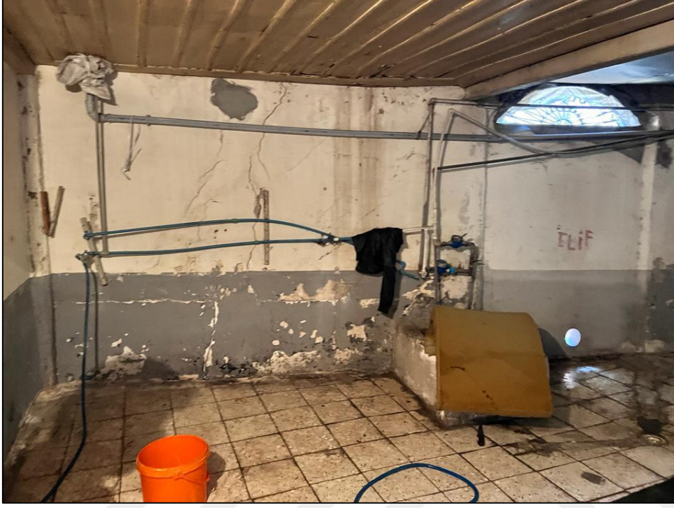
Şekil 29. Z04 Mekanındaki Bozulmalar
