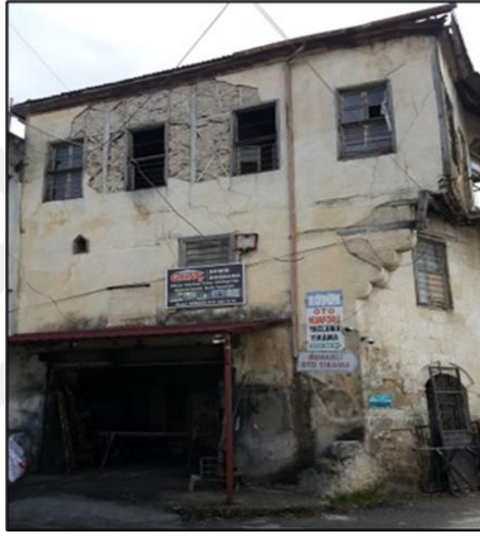
Şekil 18. Tarsus Şehit Kerim Mahallesiinde Bulunan Geleneksel Evde Bozulma Kaynak: Ömeroğlu, 2021
