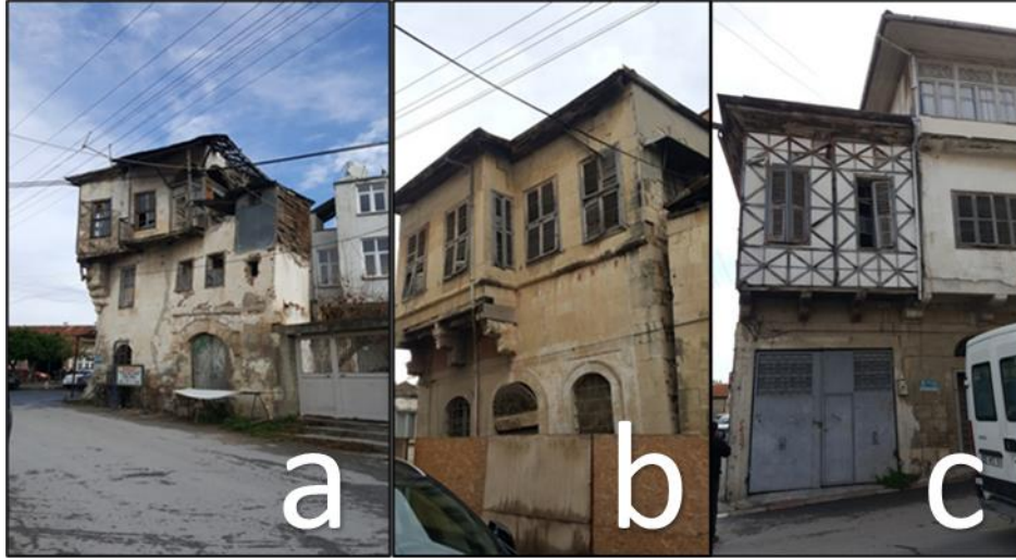
Şekil 14. Tarsus Şehit Kerim ve Cami Nur Mahallelerinde Bulunan Geleneksel Evlerden Strüktür Tasarımından Kaynaklanan Bozulma Örnekleri Kaynak: Ömeroğlu, 2021
