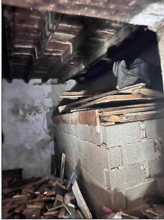
Şekil 31. Z06 Mekanındaki Bozulmalar Kaynak: Ömeroğlu, 2022
