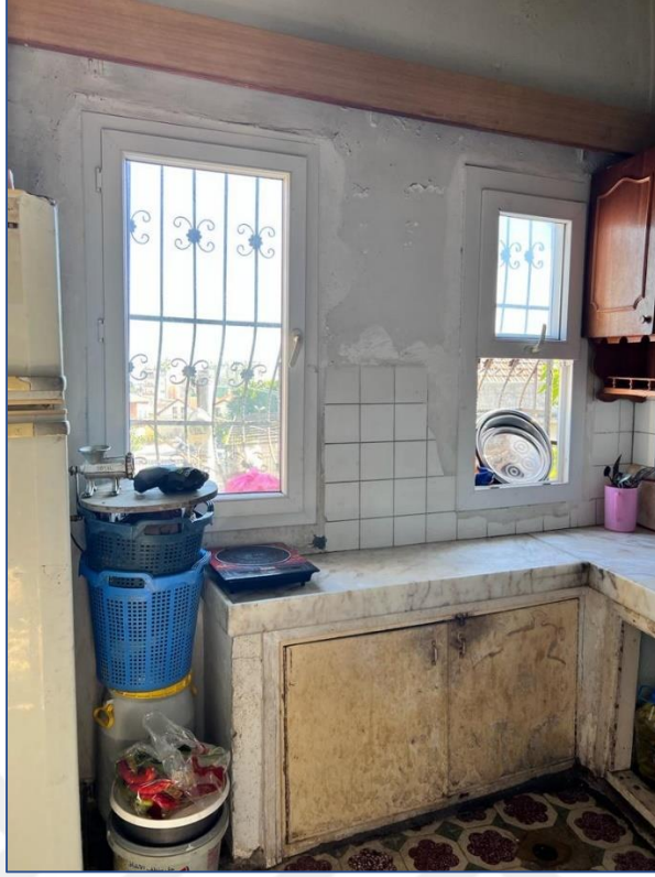
Şekil 39. 205 Bölümünde Görülen Bozulmalar
