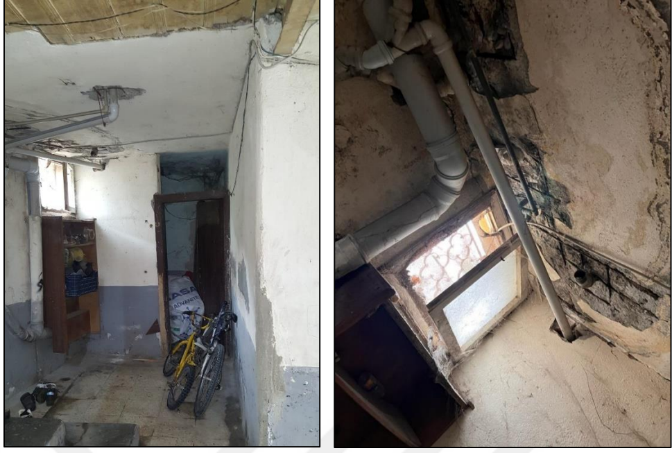
Şekil 30. Z05 Mekanındaki Bozulmalar
