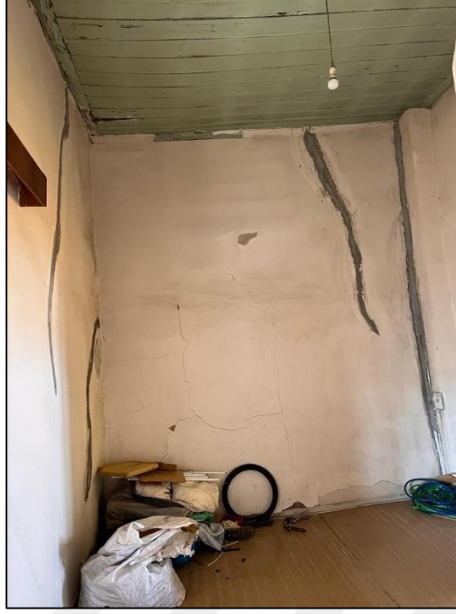
Şekil 41. 208 Bölümünde Görülen Bozulmalar
