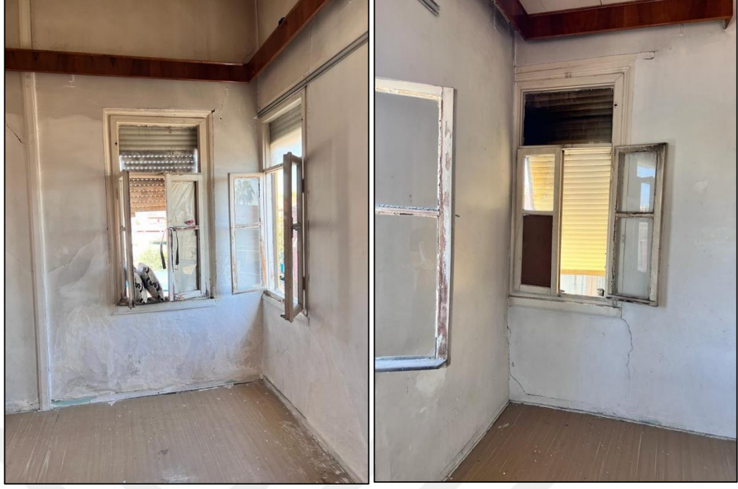
Şekil 38. 204 Bölümünde Görülen Bozulmalar
