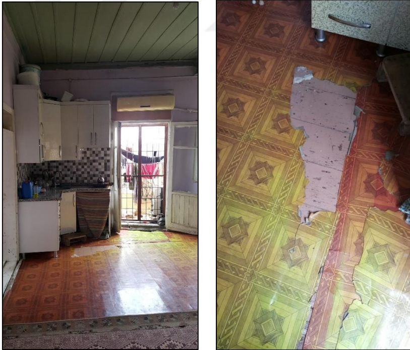
Şekil 32. 103 Mekânında Bulunan Mutfak Nişi ve Zeminde Görülen Bozulmalar Kaynak: Ömeroğlu, 2022
