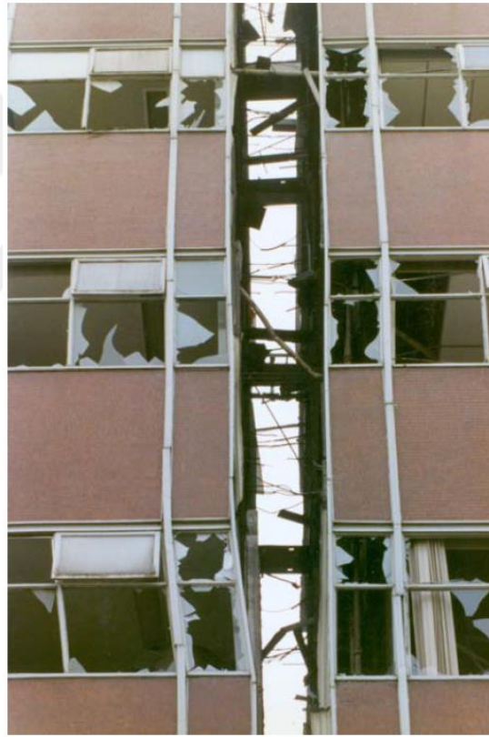
Şekil 3.7 : Eylül 1985 depreminden sonra Meksika’da bir hastane binasında ağır hasar görmüş giydirme cephe (Charleson, 2007).
