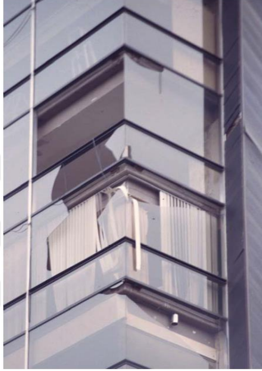
Şekil 3.8 : Eylül 1985 depreminden sonra Meksika’da bir ofis binasının üç katında da silikon derzli köşe pencerelerinde oluşan cam kırıkları (Charleson, 2007).
