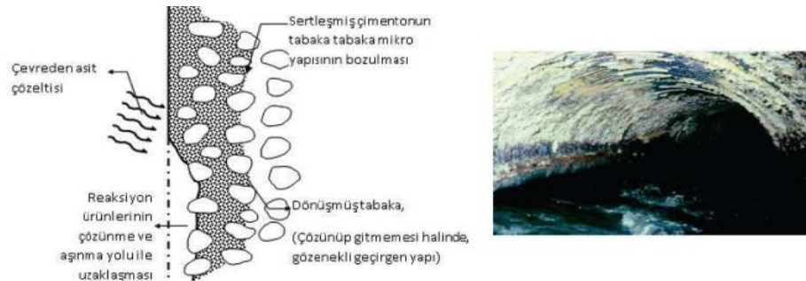
Şekil 11. Asit Etkisiyle betonun bozulma mekanizması ve kanalizasyon tüneli (Baradan ve Aydın, 2013)
