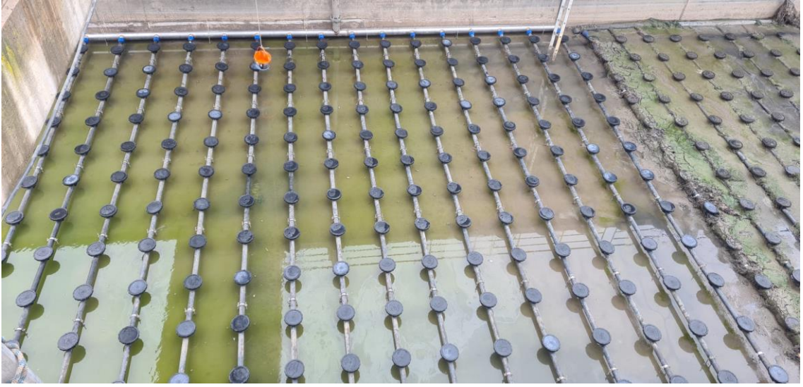
Şekil 5.6. Havalandırma havuzu difüzör yapısı.
