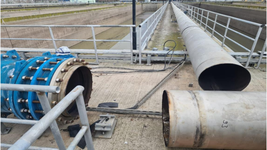
Şekil 5.4. Havalandırma havuzu hava hattı.
