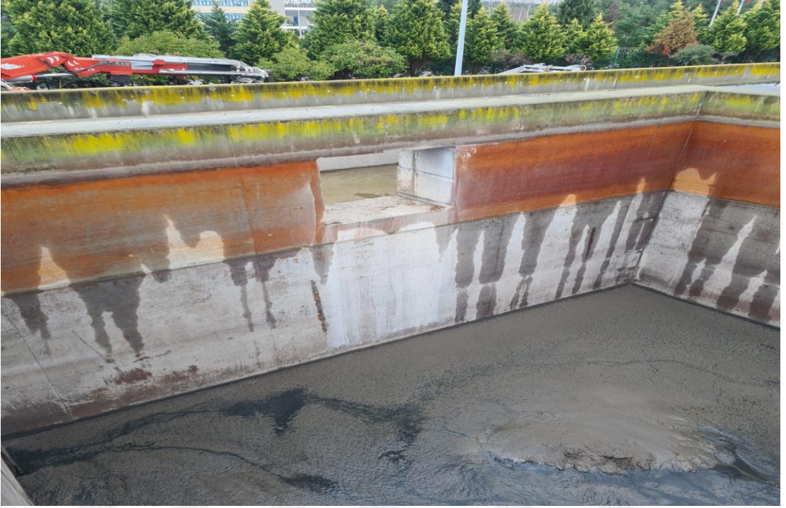
Şekil 5.2. Havalandırma havuzu atıksu giriş yapısı.
