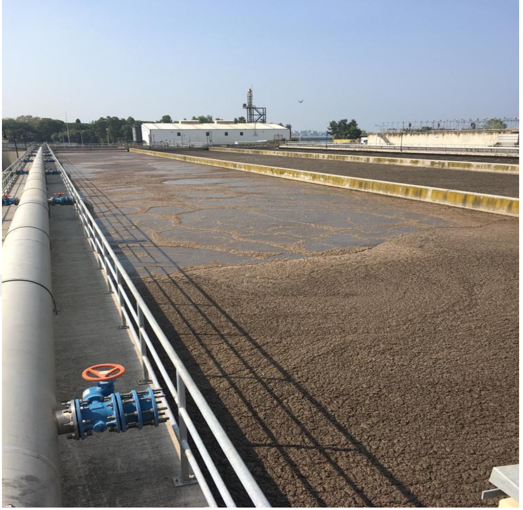
Şekil 5.8. Havalandırma havuzu iyileştirme sonrası.
