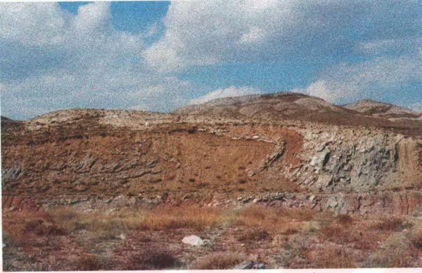
Şekil 108: İnceleme alanının orta kesiminde Üst Oligosen yaşlı Emirhan formasyonu (Te) içinde gelişen ve demiryolu yarmasında gözlenen yatık kıvrımların görünümü (Karapur Tepe güneyindeki demiryolu yarmasından K'ye doğru bakış)
