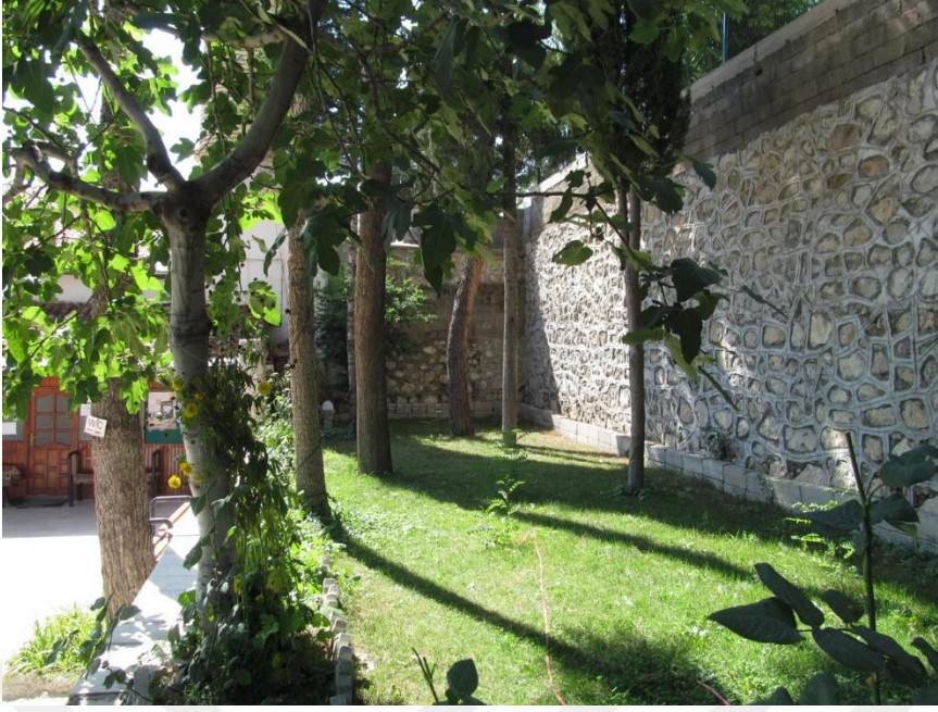
Şekil A.130 : Hızır Paşa Külliyesi kuzy istinat duvarı.
