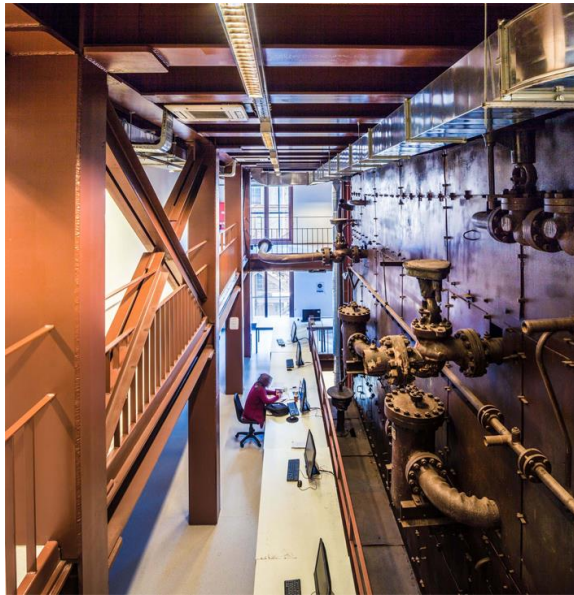
Resim 3.7 Eğitim Yapısına Dönüştürülen 6 Nolu Binadaki Mevcut 13 Nolu Kazan (URL-16, 2016)
