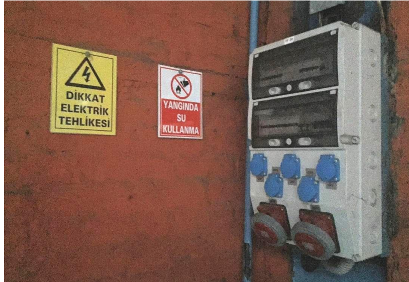
Şekil 5.20. Elektrik panosu tehlike ve uyarı tabelaları gösterimi.
