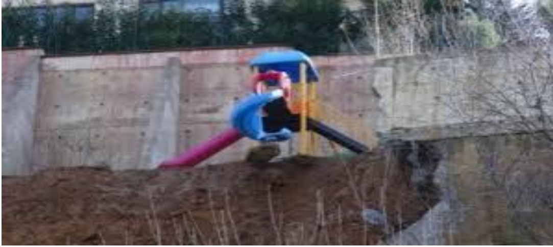
Şekil 4.21 : İstinad duvarı çalışması nedeniyle çöken çocuk parkı (Url-41).
