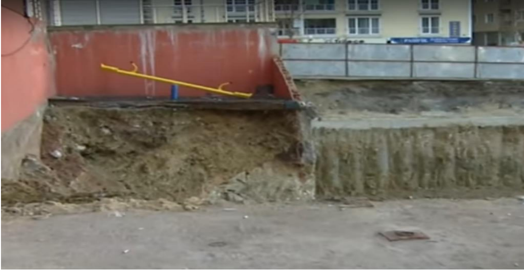
Şekil 4.20 : Komşu parseldeki inşaat çalışması nedeniyle çöken çocuk parkı(Url-40).
