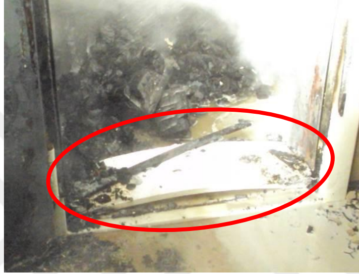
Şekil 5.1. 136 dakikada, 951 °C'ye ulaşan doğal yangının sonunda mermer eşiğin durumu (26.3.2013)
