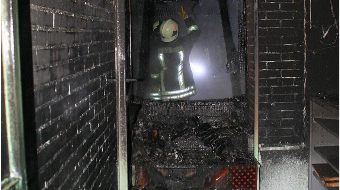
Şekil 2.4. Fahrünnisa Cami yangını (Akbıyık, 2015b)
