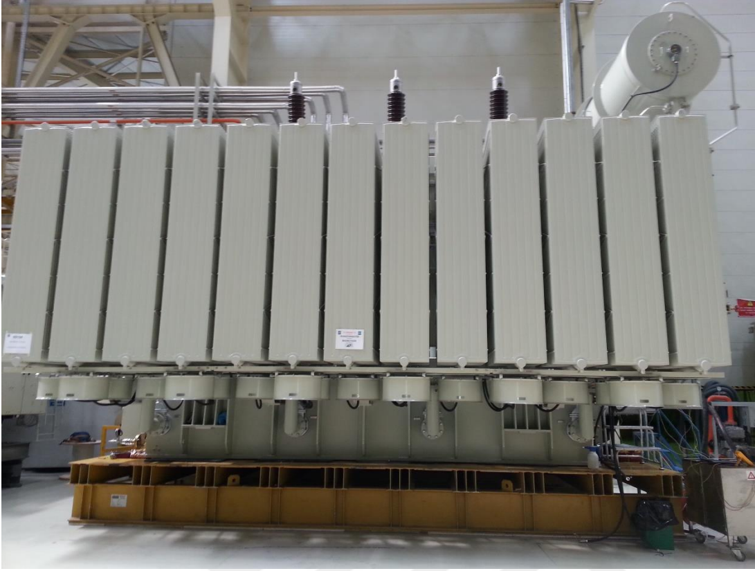
Şekil 5.1 : Test edilen transformatör fotoğrafı.
