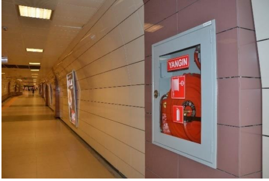
Şekil 5.98 Kartal İstasyonu, yangın dolabı
