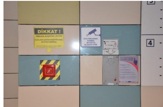
Şekil 5.22 Kadıköy İstasyonu, perondaki diafon ve acil durum butonu
