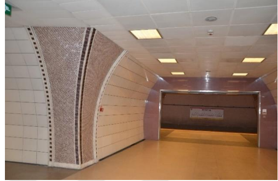
Şekil 5.84 Kartal İstasyonu, peronda bulunan yangın perdesi
