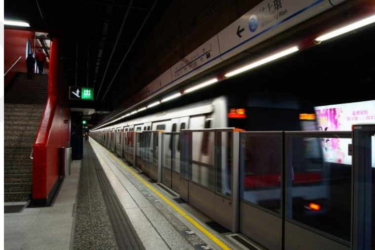
Şekil 3.41 Yarım boy peron ayırıcı kapı sistemi örneği: Çin, Hong Kong, Heng Fa Chuen İstasyonu [68]
