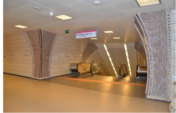
Şekil 5.96 Kartal İstasyonu, merdiven tüneli aydınlatması
