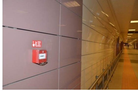
Şekil 5.99 Kartal İstasyonu, yangın ihbar butonu
