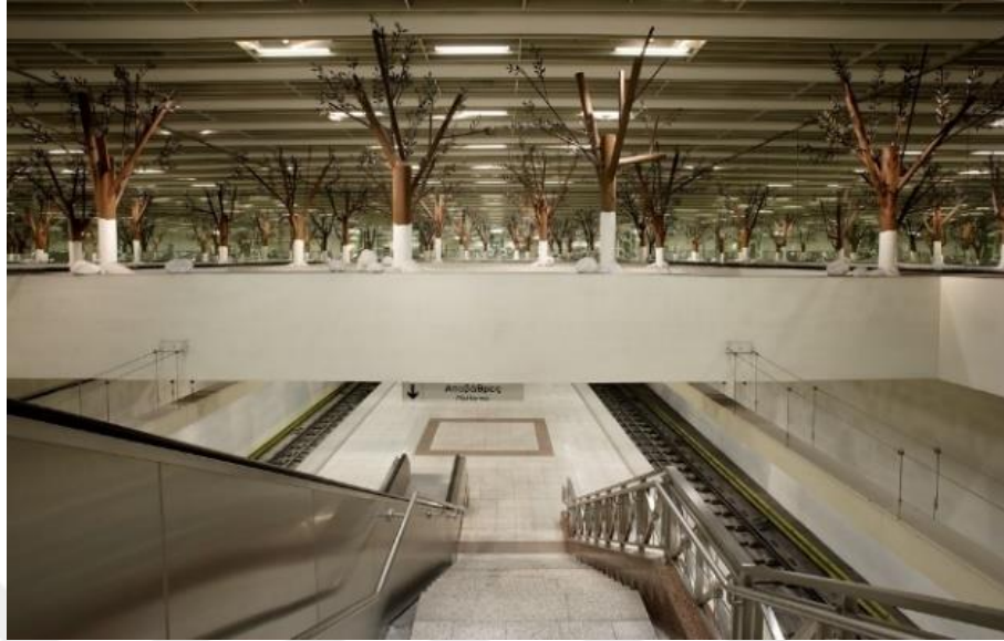
Şekil 4.27 Yer altı metro istasyonunda enstalasyon örneği: Yunanistan, Ethniki Amnya İstasyonu [151]
