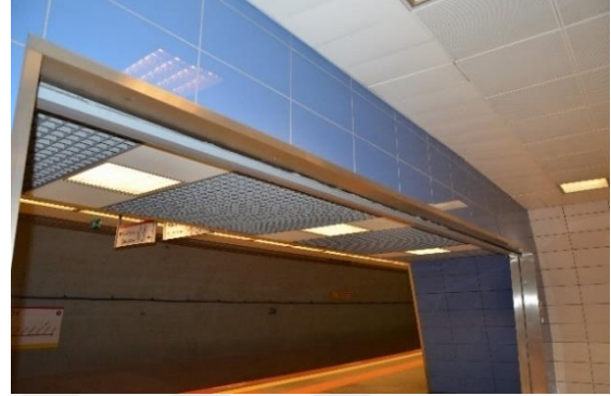
Şekil 5.24 Kadıköy İstasyonu, peronda bulunan yangın perdesi
