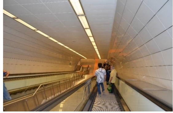
Şekil 5.33 Kadıköy İstasyonu, merdiven tüneli aydınlatması
