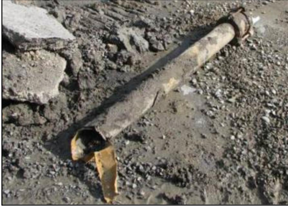
a) Sarmal Perçinlenmiş Çelik Boru Hasarı
