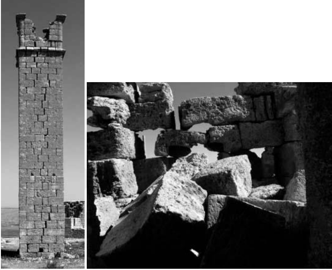
Resim 109: Ürdün'de Bizans Dönemi'ne ait bir kilisenin kulesinde görülen deprem kaynaklı hasar (Koellisch 2007)
